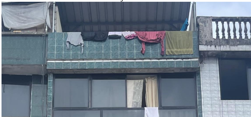
Anexo 107. Presencia de humedad y moho
