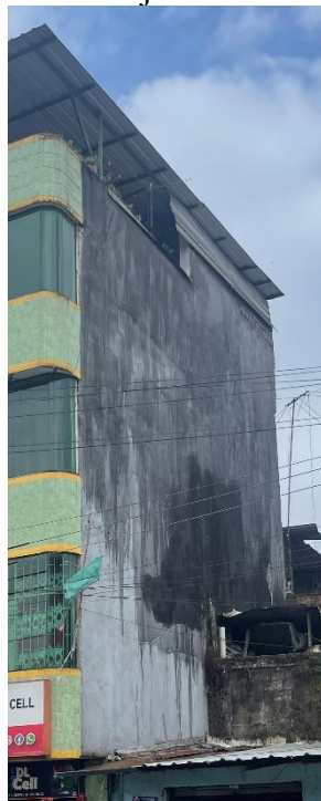
Anexo 111. Presencia de humedad y moho
