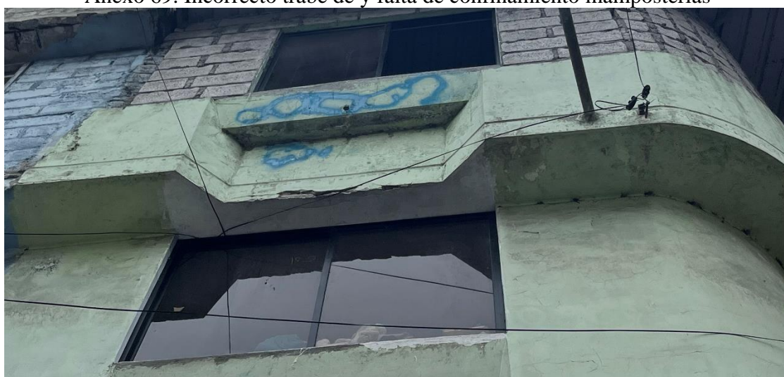
Anexo 70. Erosión de los materiales
