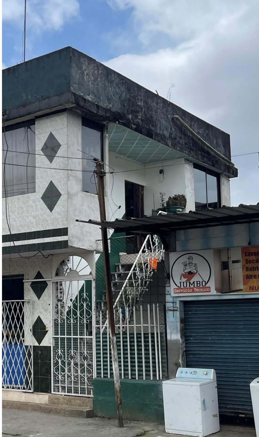
Anexo 45. Erosión de los materiales, humedad y moho
