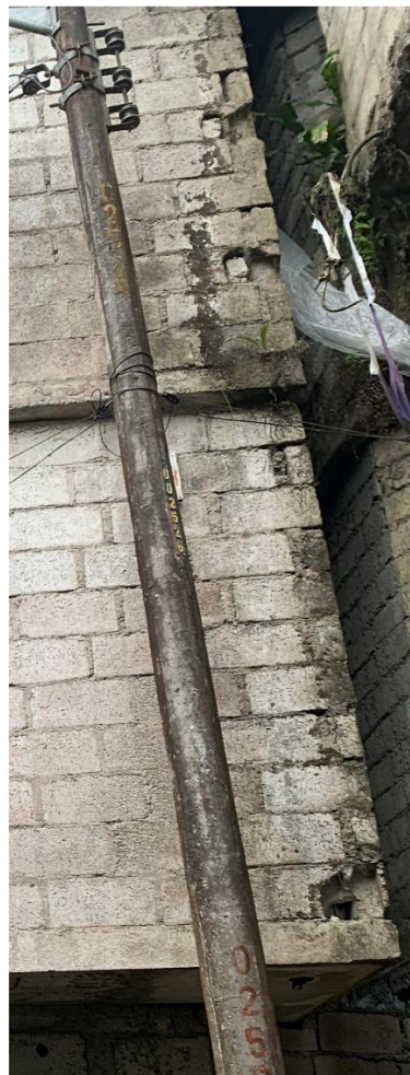
Anexo 17. Humedad y moho
