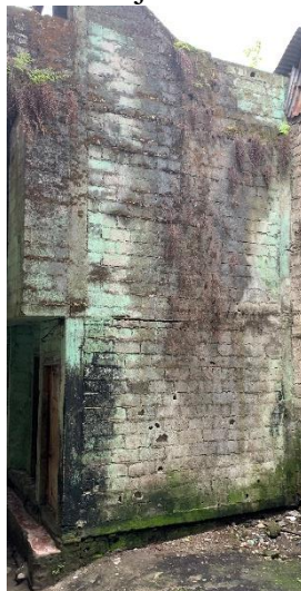
Anexo 28. Erosión de los materiales, humedad y vegetación
