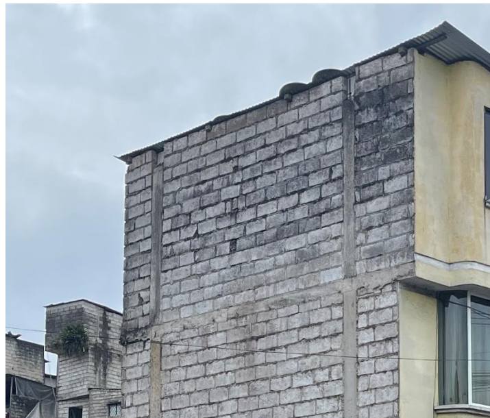
Anexo 48. Trabado irregular de mampostería y falta de confinamiento superior
