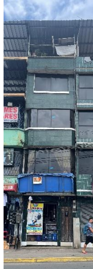
Anexo 103. Sin juntas constructivas
