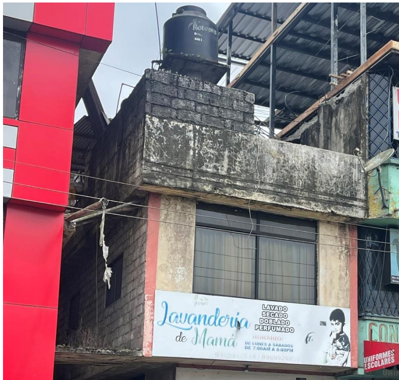
Anexo 100. Materiales erosionados, con humedad y moho
