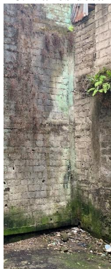
Anexo 27. Sin junta constructiva
