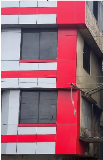
Anexo 98. Materiales erosionados, con humedad y moho
