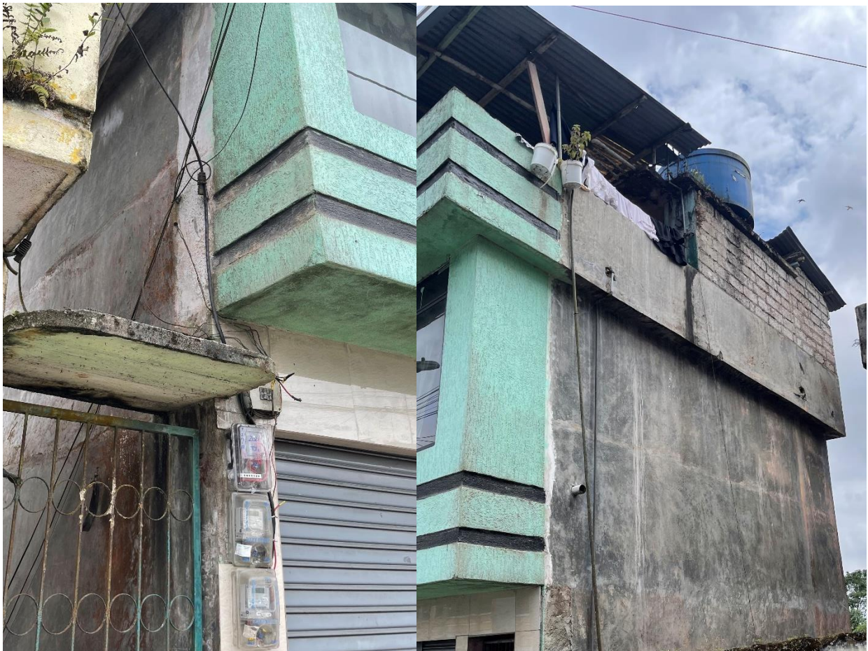
Anexo 48,1. Erosión de los materiales, humedad, moho y vegetación parásita
