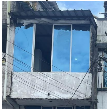
Anexo 90. Materiales erosionados, con humedad y moho
