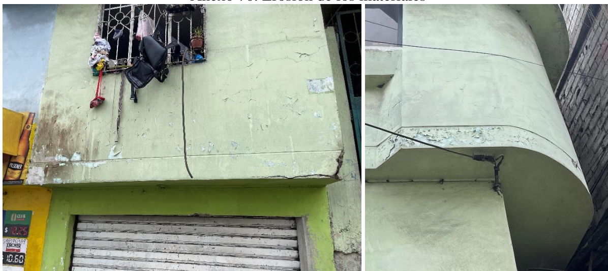
Anexo 71. Presencia de moho y erosión de materiales
