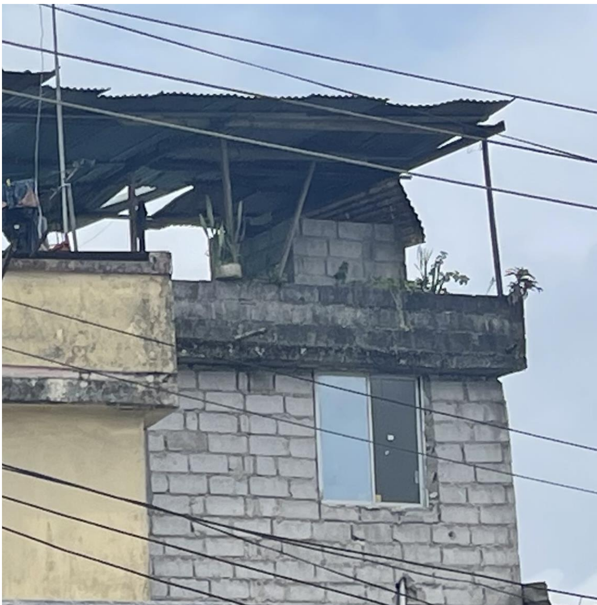
Anexo 44. Erosión de los materiales, humedad, moho y vegetación parásita
