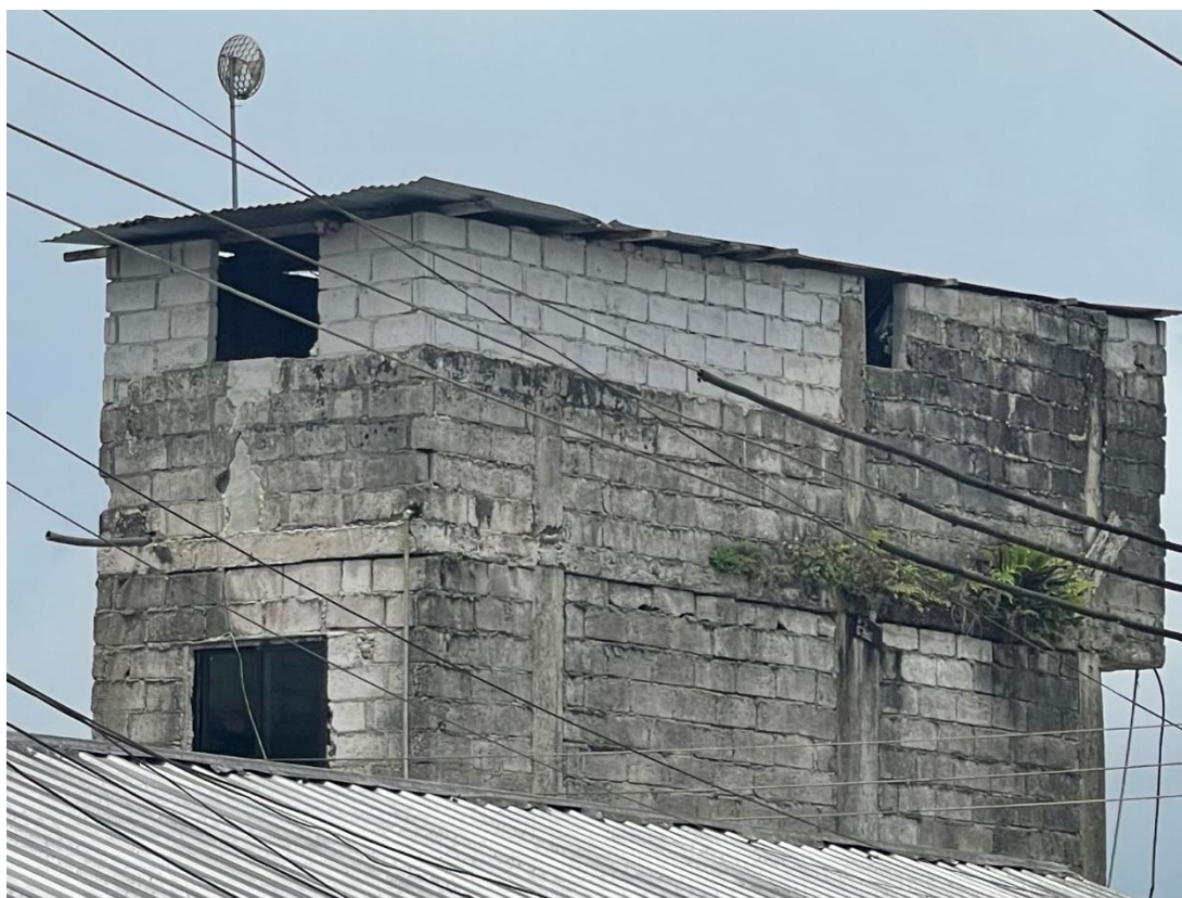
Anexo 41. Erosión de los materiales, humedad, moho y vegetación parásita
