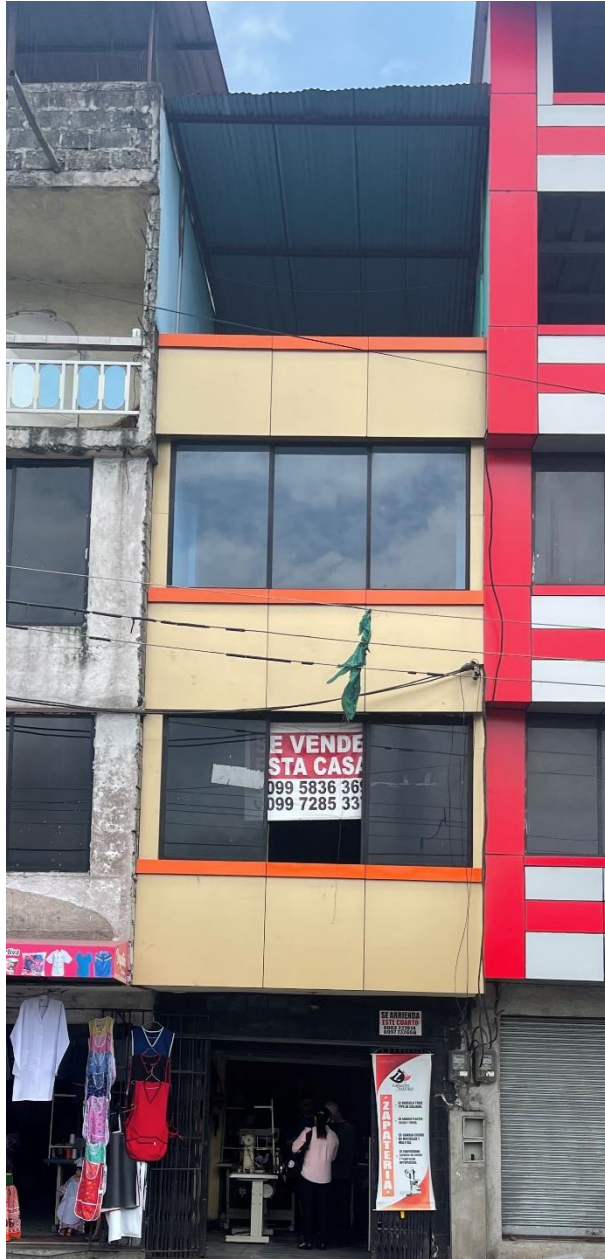
Anexo 95. Sin juntas constructivas
