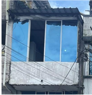
Anexo 80. Incorrecto confinamiento superior de la mampostería
