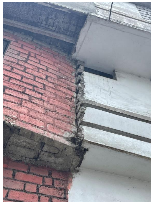
Anexo 73. Sin juntas constructivas
