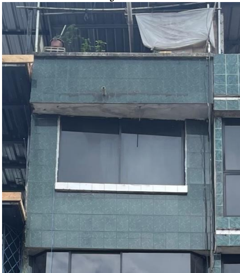
Anexo 104. Presencia de humedad en losa
