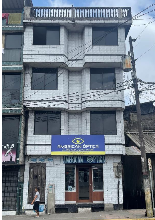
Anexo 108. Sin junta constructiva
