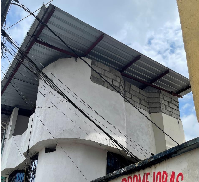
Anexo 54. Falta de confinamiento superior de la mampostería
