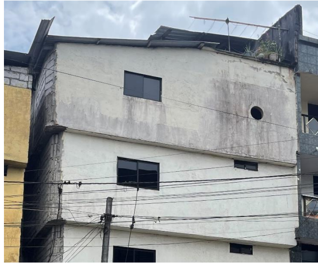
Anexo 58. Falta de confinamiento de mamposterías
