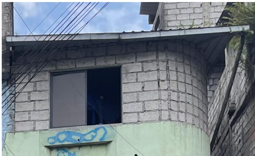
Anexo 69. Incorrecto trabe de y falta de confinamiento mamposterías
