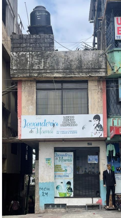
Anexo 99. Sin junta constructiva
