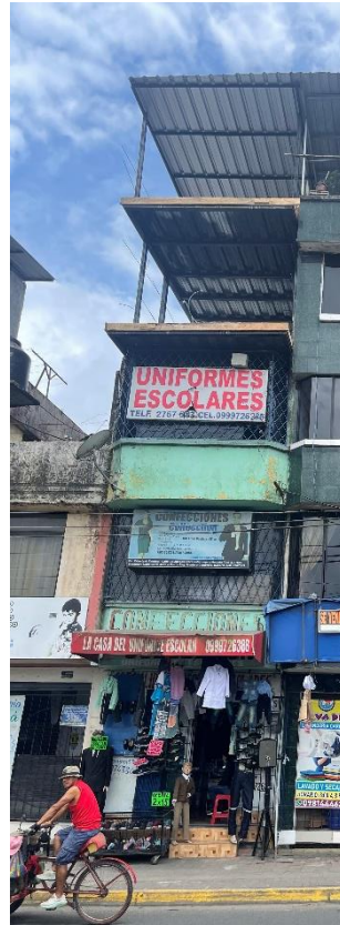
Anexo 101. Sin juntas constructivas
