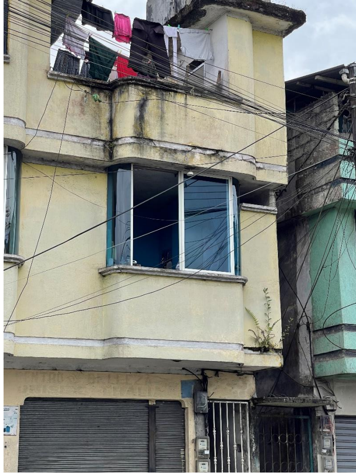
Anexo 47,1. Erosión de los materiales, humedad, moho y vegetación parásita
