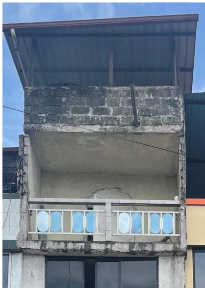
Anexo 94. Materiales erosionados, con humedad y moho
