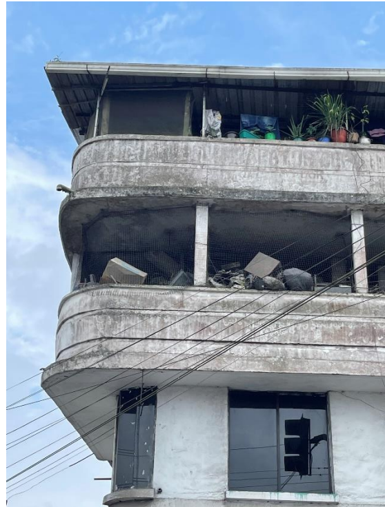
Anexo 79. Materiales erosionados, con humedad y moho
