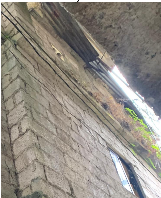
Anexo 36. Erosión de los materiales, humedad, moho y vegetación parásita
