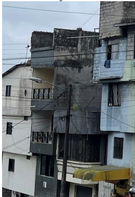
Anexo 62. Erosión de los materiales, humedad y presencia de moho
