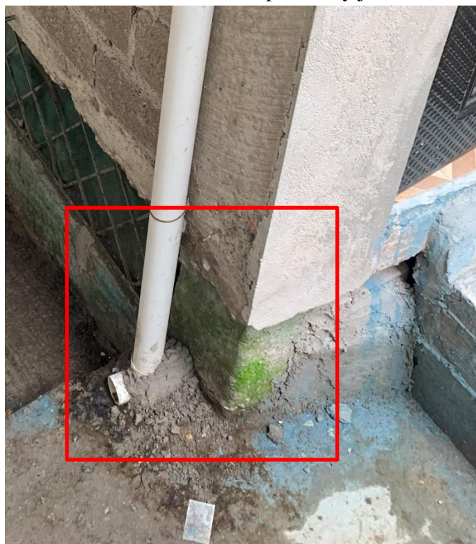
Anexo 9. Humedad y presencia de moho
