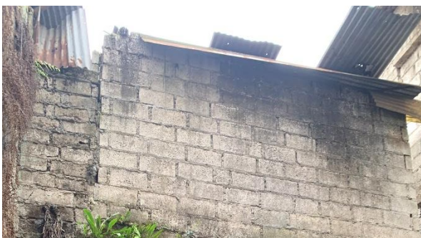
Anexo 18. Incorrecto trabado y falta de confinamiento de mamposterías
