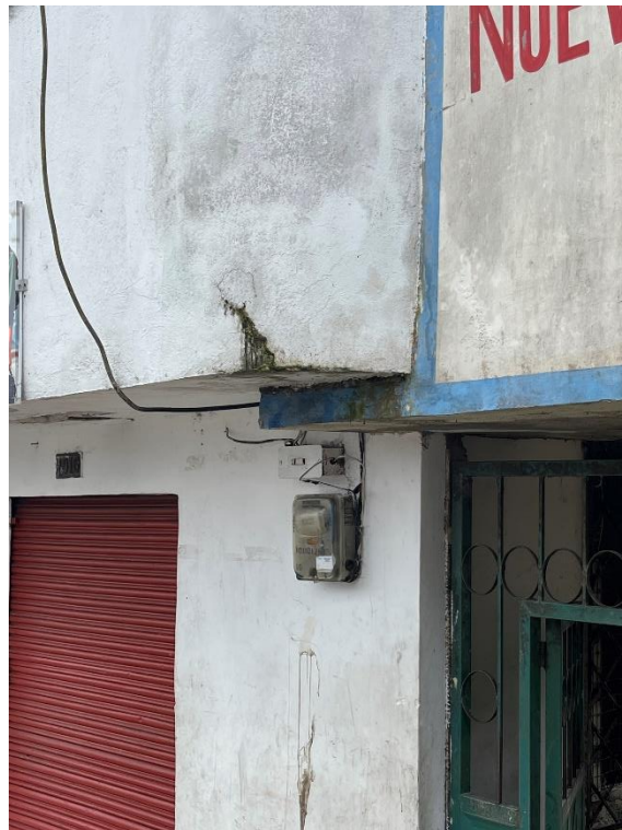
Anexo 55. Presencia de moho
