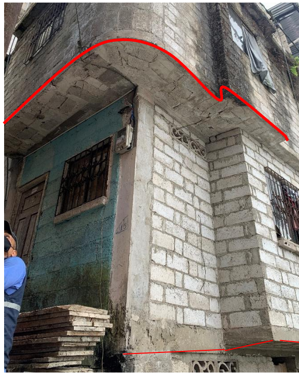
Anexo 11. Planta irregular y vanos desalineados
