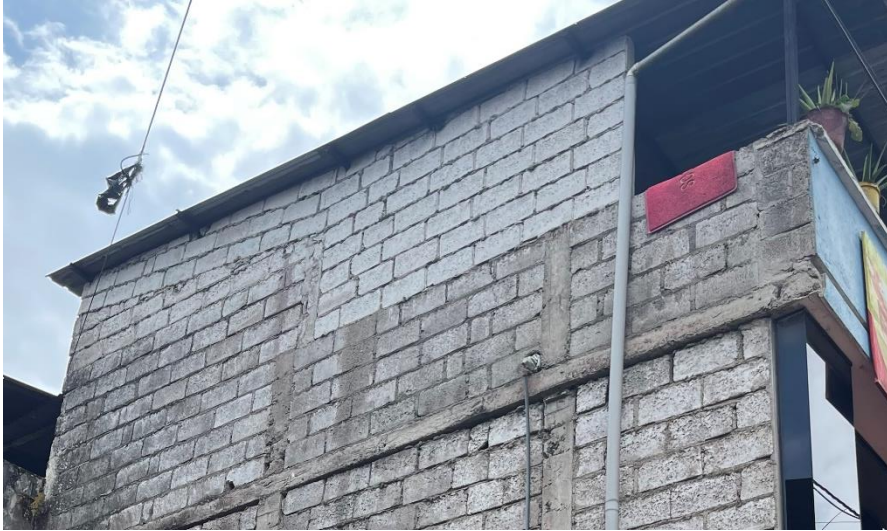
Anexo 49. Trabe irregular de mampostería y falta de confinamiento superior
