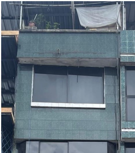
Anexo 105. Presencia de moho
