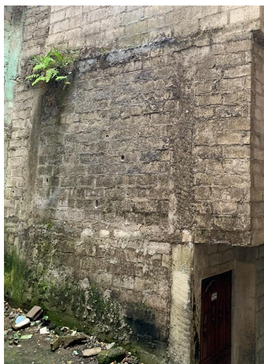
Anexo 21. Materiales erosionados, con humedad y vegetación
