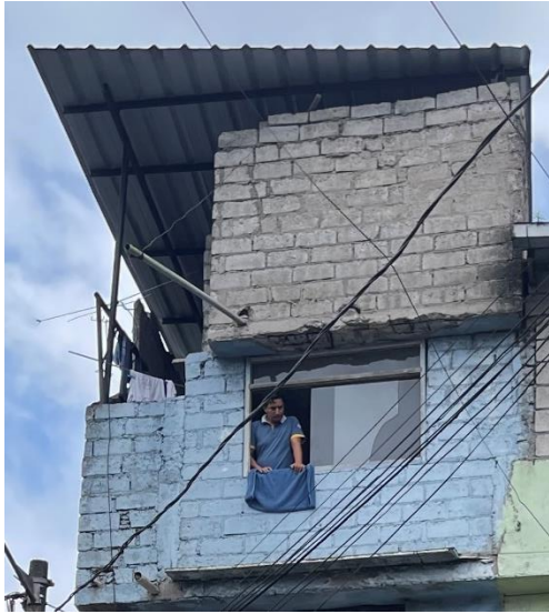
Anexo 64. Incorrecto trabado y falta de confinamiento superior de mamposterías
