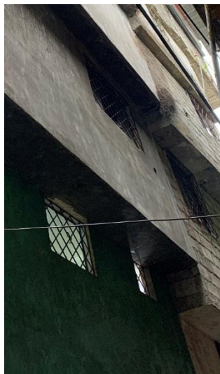
Anexo 29. Vanos desalineados
