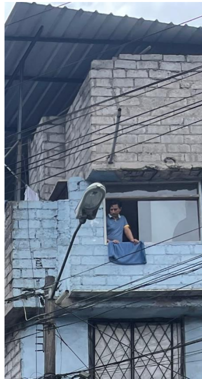
Anexo 65. Falta de continuidad de columnas, planta irregular y vanos desalineados
