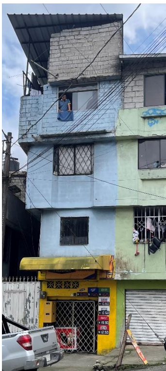
Anexo 66. Sin juntas constructivas
