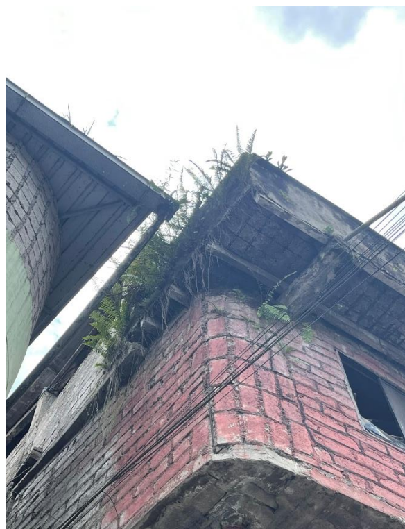
Anexo 75. Materiales con humedad, moho y vegetación parásita
