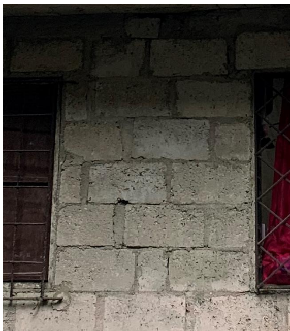
Anexo 14. Incorrecto trabe de mamposterías
