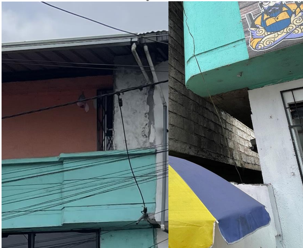
Anexo 53. Erosión de los materiales y presencia de moho
