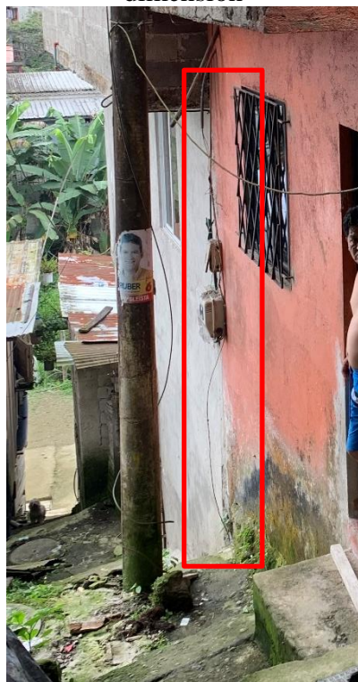
Anexo 3. Sin junta constructiva
