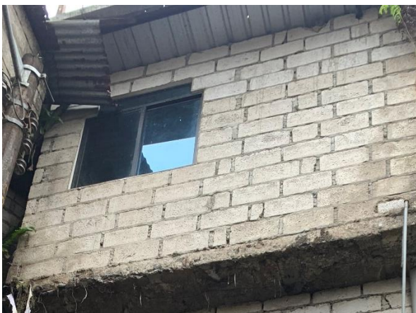
Anexo 22. Incorrecto trabado y falta de confinamiento de mamposterías
