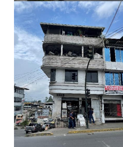
Anexo 78. Sin juntas constructivas
