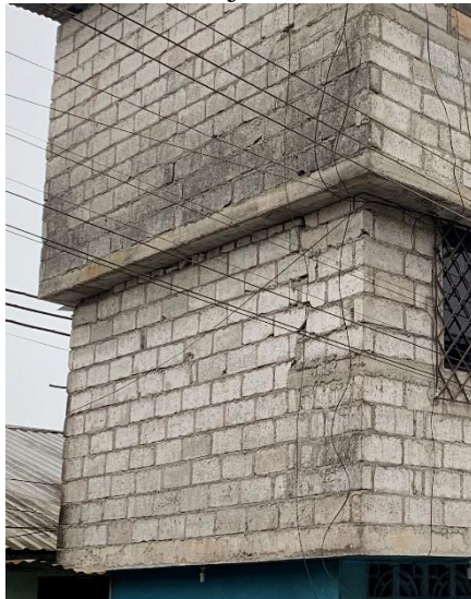
Anexo 114. Erosión de los materiales y presencia de moho
