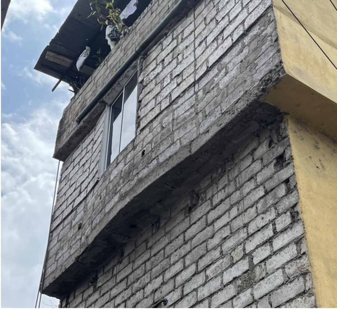
Anexo 56. Inadecuada disposición del trabe de la mampostería
