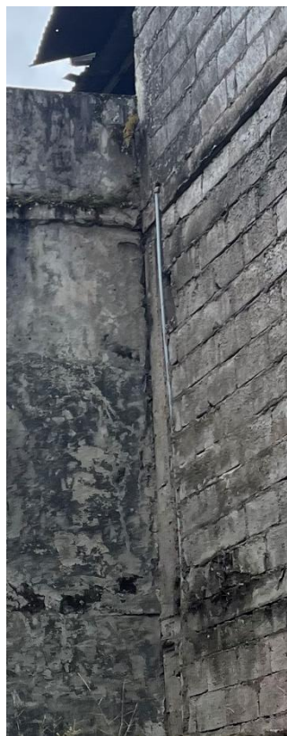
Anexo 37. Sin junta constructiva
