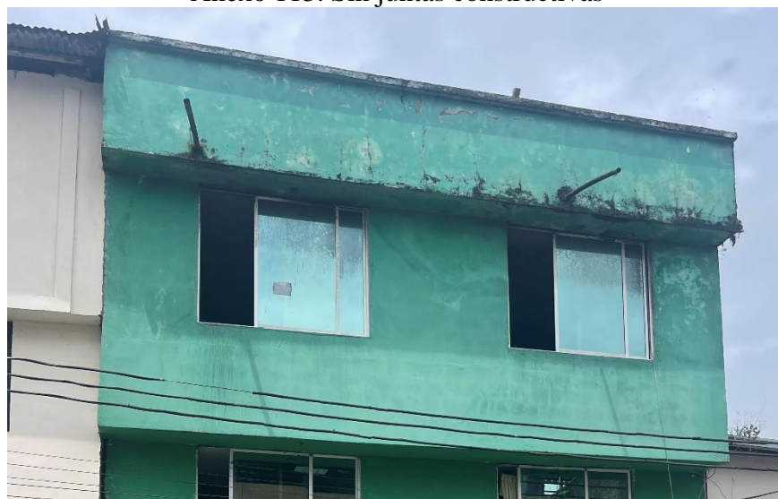
Anexo 115. Erosión de los materiales, presencia de humedad, moho y vegetación
