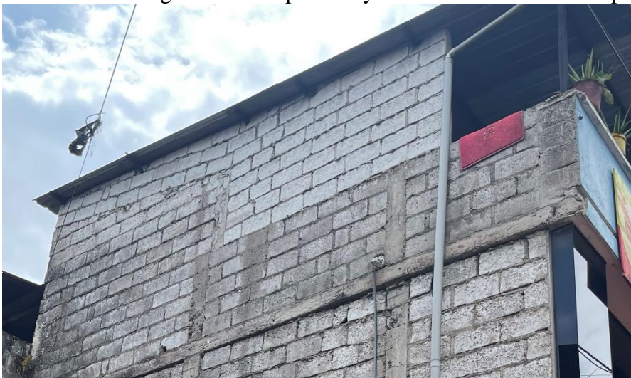
Anexo 50. Discontinuidad de las columnas
