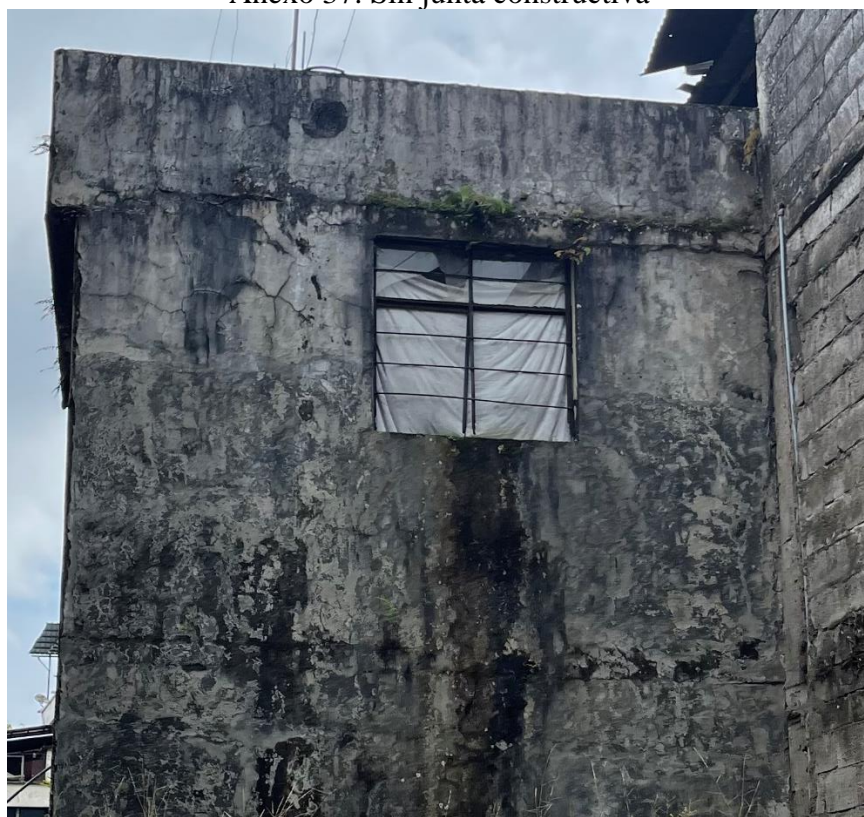
Anexo 38. Erosión de los materiales, humedad, moho y vegetación parásita
