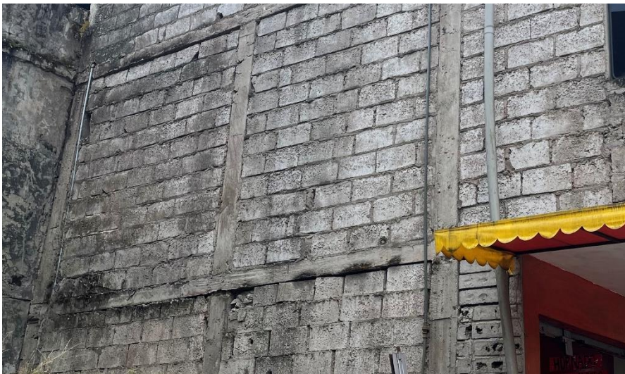
Anexo 51. Erosión de los materiales, humedad, moho y vegetación parásita
