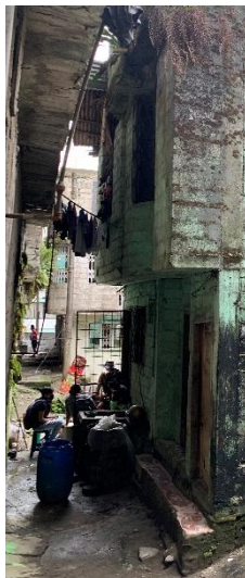
Anexo 26. Vanos desalineados
