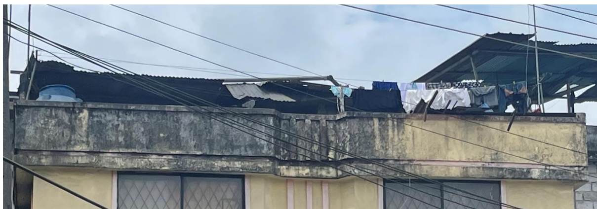
Anexo 43. Presencia de humedad y moho
