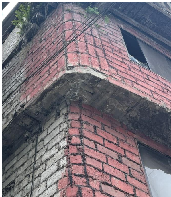
Anexo 72. Incorrecto trabado de mamposterías
