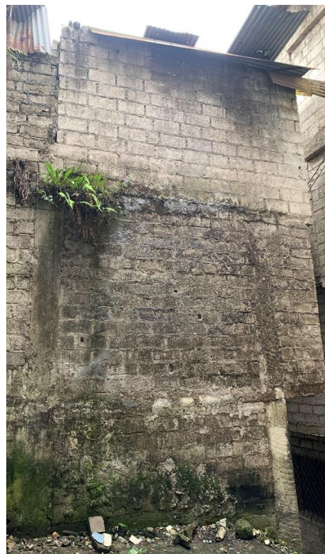
Anexo 19. Falta de continuidad de columnas y vanos desalineados
