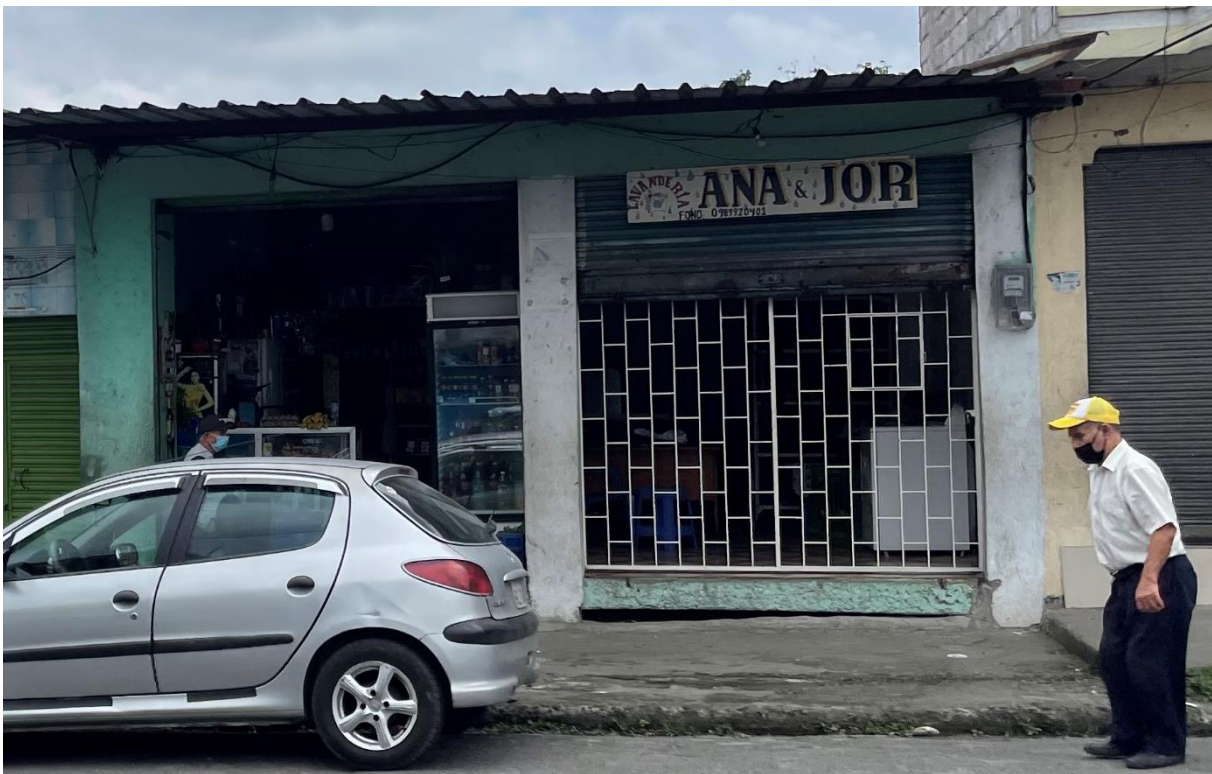
Anexo 47. Sin junta constructiva y erosión de materiales
