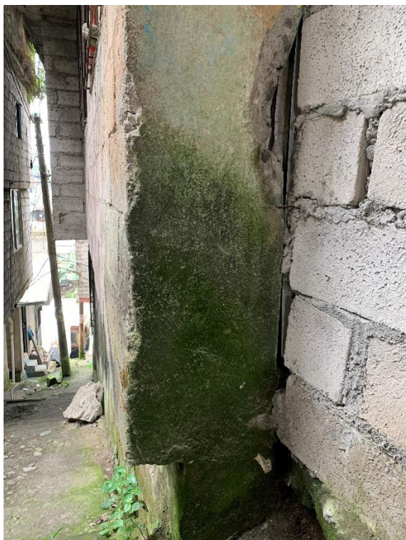
Anexo 16. Erosión de los materiales
