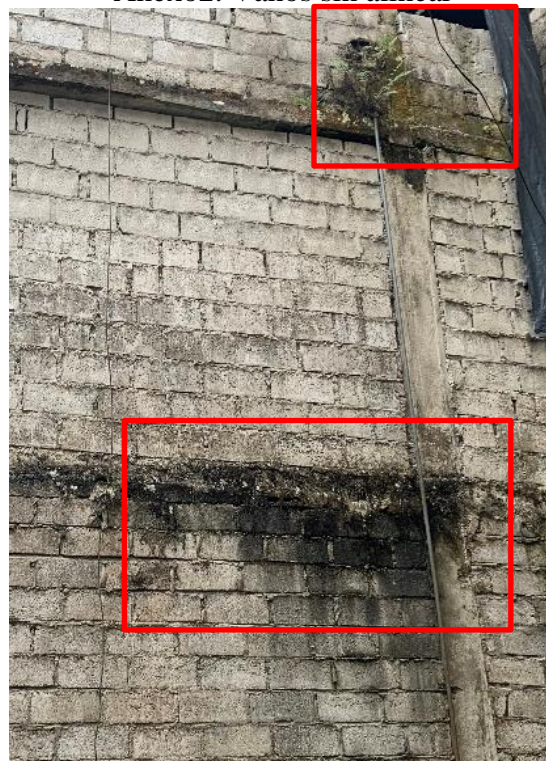
Anexo 4. Humedad, vegetación y erosión
