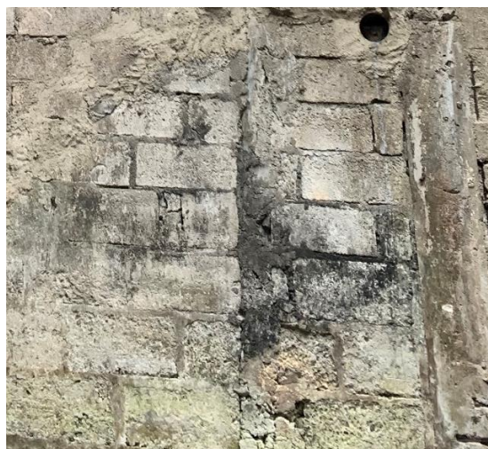
Anexo 25. Materiales erosionados, con humedad y moho
