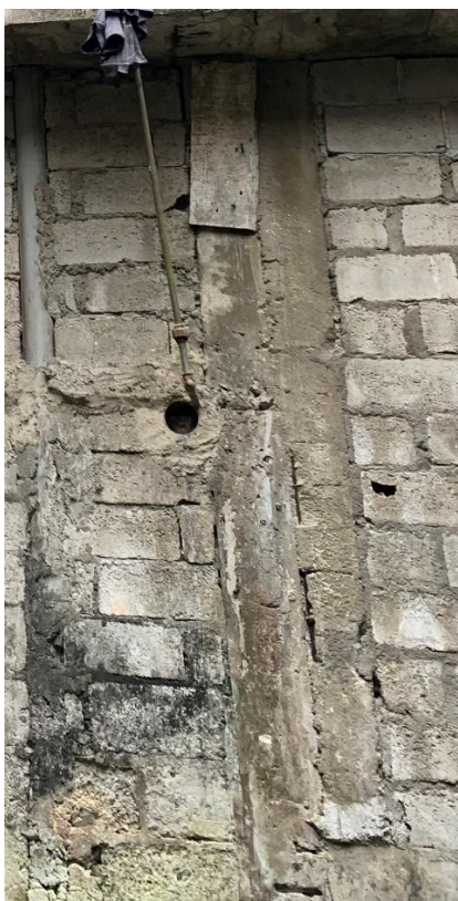
Anexo 24. Sin juntas constructivas
