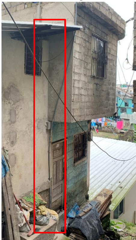
Anexo 12. Sin junta constructiva
