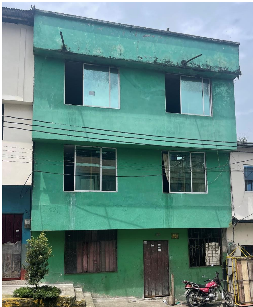
Anexo 113. Sin juntas constructivas
