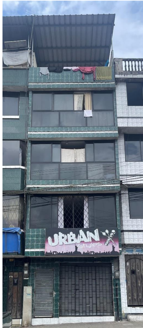
Anexo 106. Sin juntas constructivas
