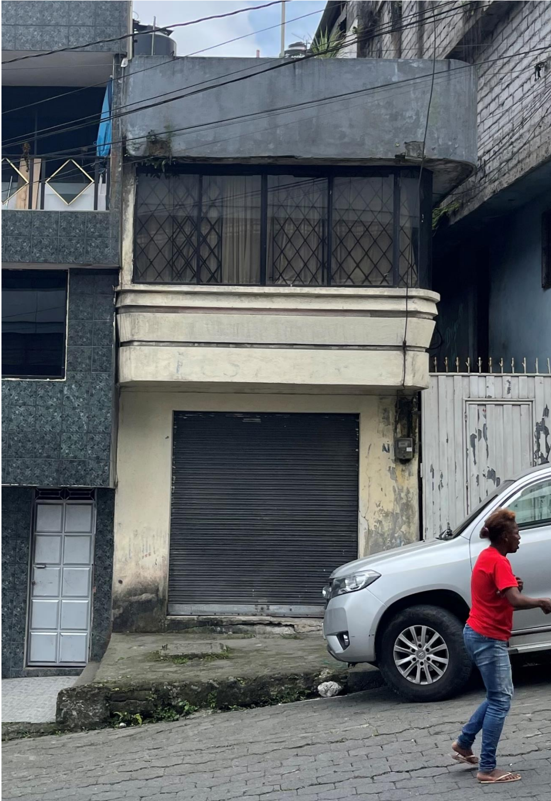
Anexo 63. Erosión de los materiales, humedad y presencia de moho
