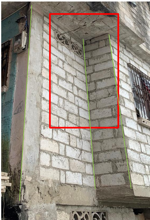
Anexo 10. Sin confinamiento e incorrecto trabe de mampostería
