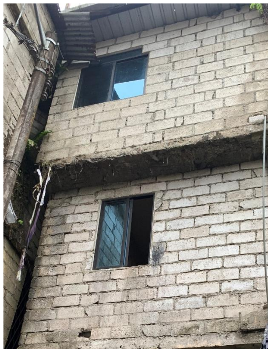
Anexo 23. Vanos desalineados
