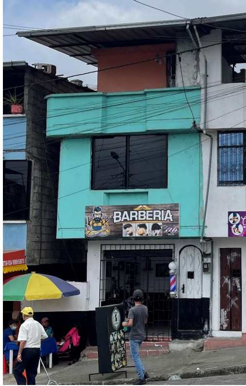
Anexo 52. Sin junta constructiva
