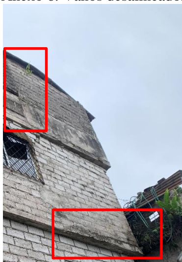
Anexo 7. Erosión de los materiales, humedad y vegetación parásita
