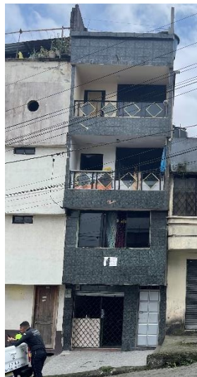
Anexo 59. Sin junta constructiva
