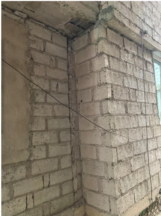
Anexo 35. Sin junta constructiva
