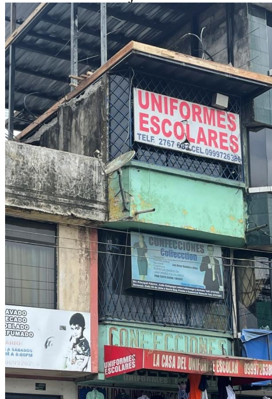
Anexo 102. Materiales erosionados, con humedad y moho
