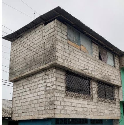
Anexo 112. Incorrecto trabado y falta de confinamiento superior de mamposterías
