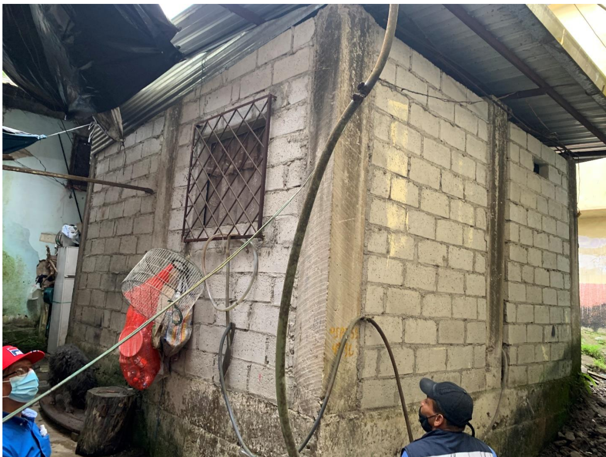
Anexo 33. Erosión de los materiales, humedad y moho
