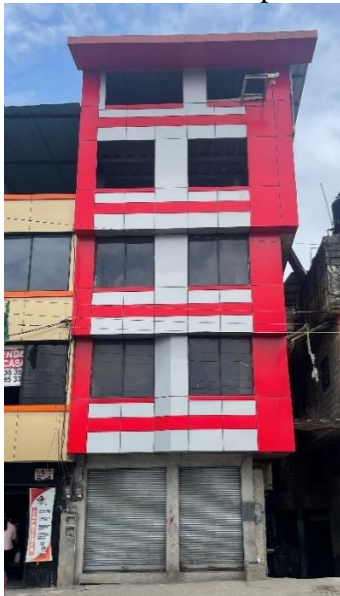
Anexo 97. Sin junta constructiva
