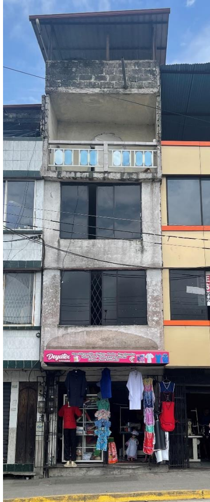
Anexo 93. Sin juntas constructivas
