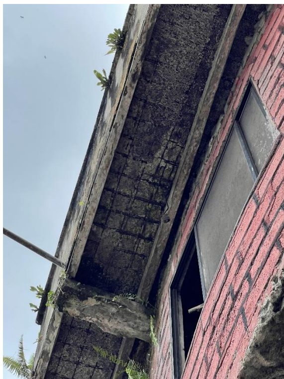
Anexo 74. Erosión de los materiales
