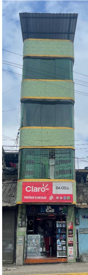
Anexo 110. Sin juntas constructivas
