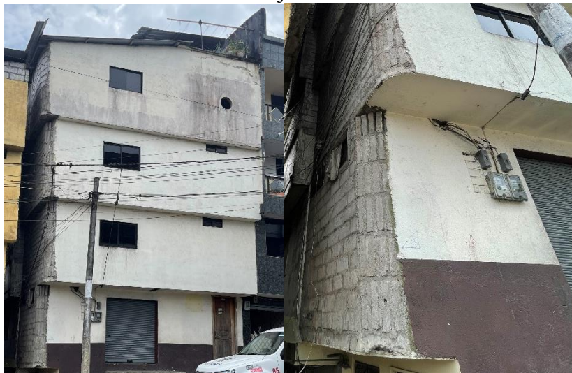
Anexo 60. Erosión de los materiales y presencia de moho
