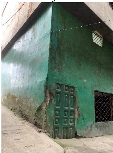
Anexo 31. Erosión de los materiales, humedad y moho
