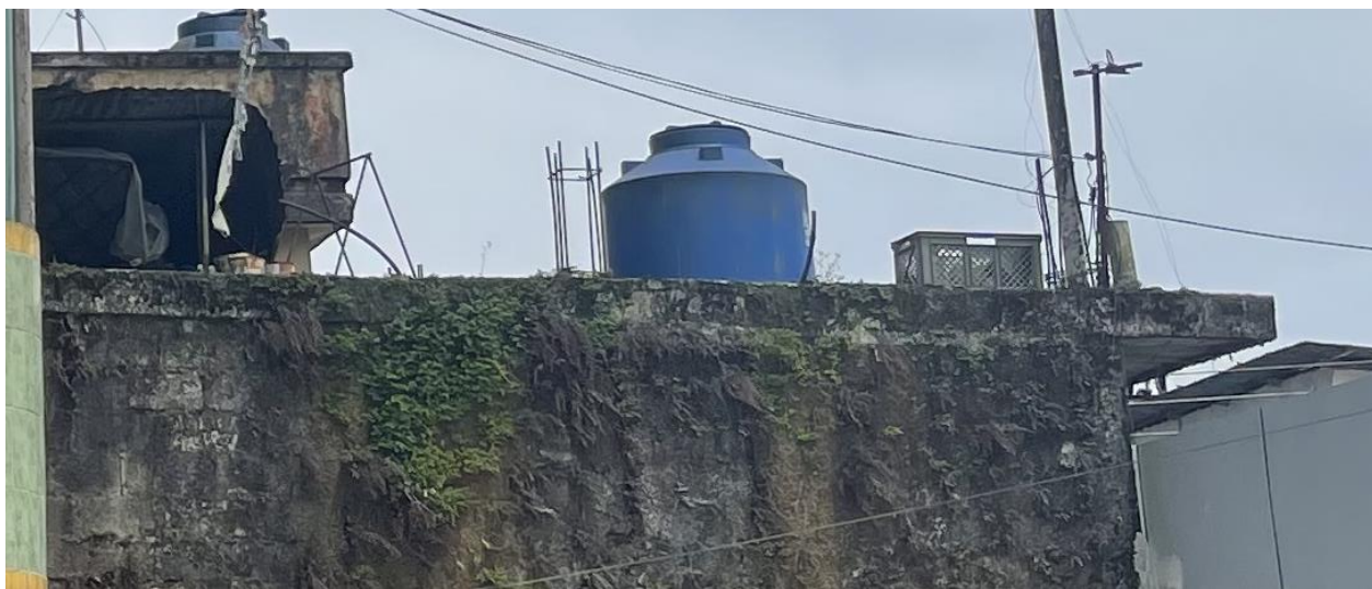
Anexo 39. Erosión de los materiales, humedad, moho y vegetación parásita
