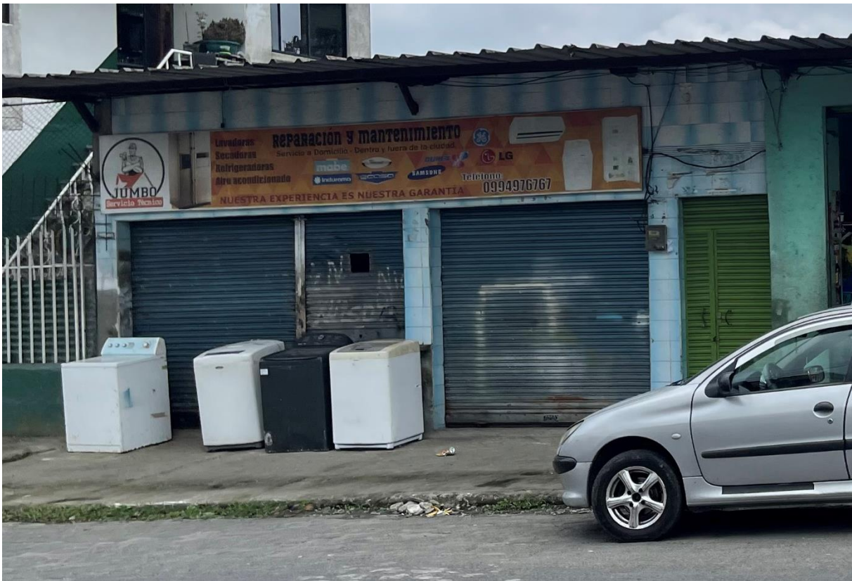
Anexo 46. Sin junta constructiva y falta de confinamiento superior
