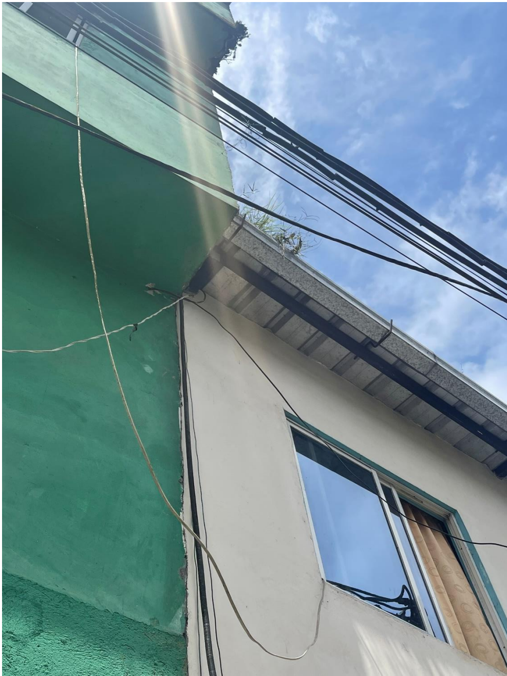
Anexo 116. Sin junta constructiva
