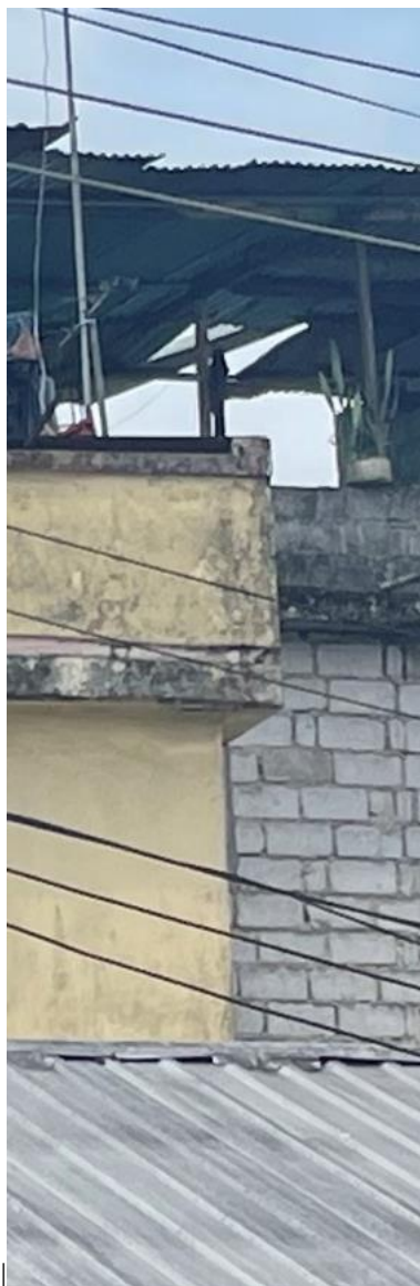
Anexo 42. Sin junta constructiva
