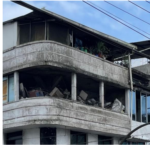
Anexo 77. Discontinuidad de columnas
