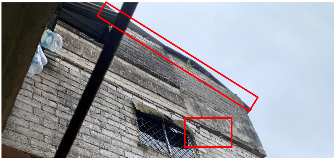
Anexo 5. Incorrecto trabado y sin confinamiento en la cubierta
