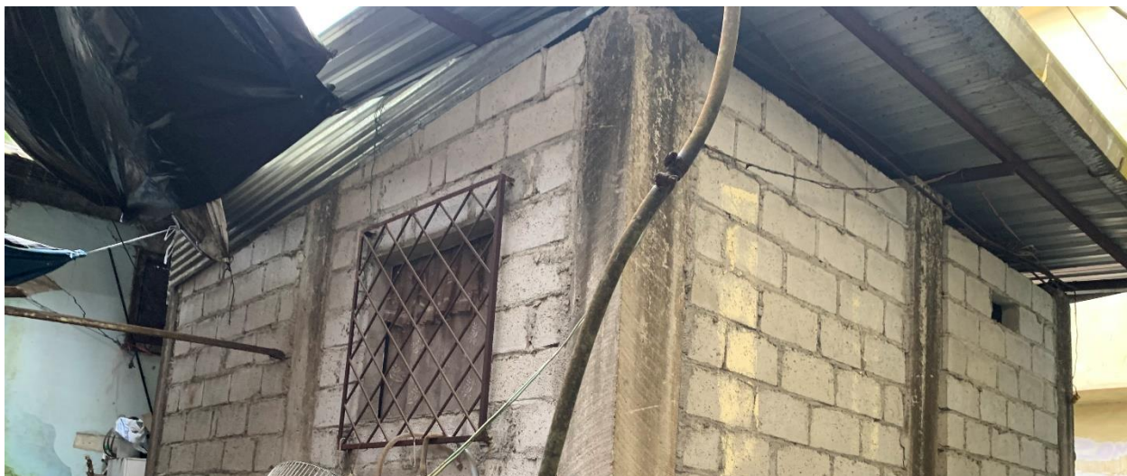
Anexo 32. Falta de confinamiento superior
