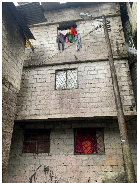
Anexo 15. Vanos desalineados
