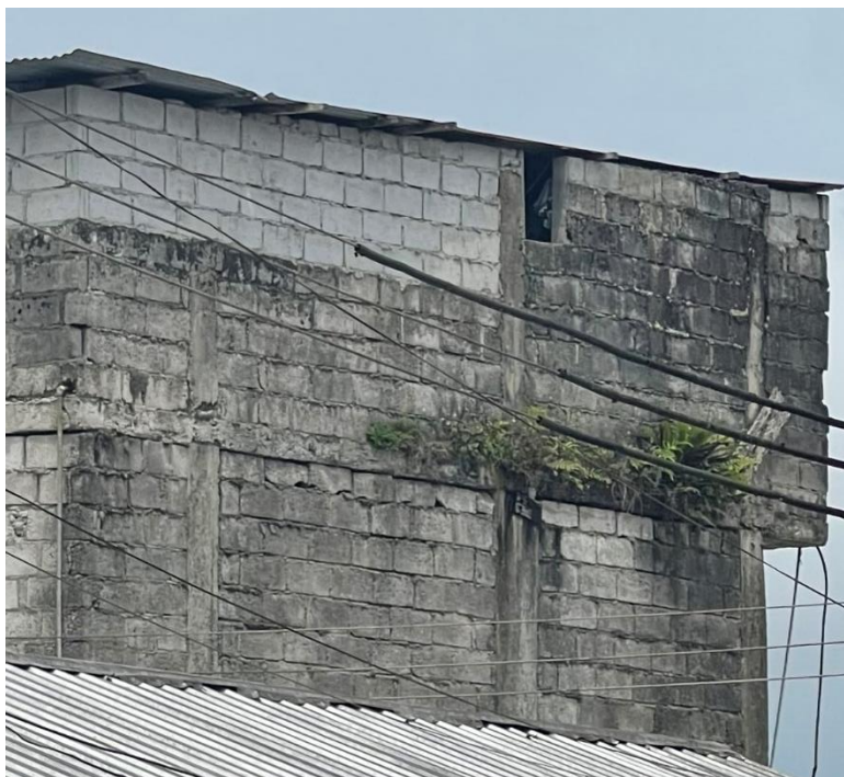
Anexo 40. Falta de confinamiento y discontinuidad en columnas
