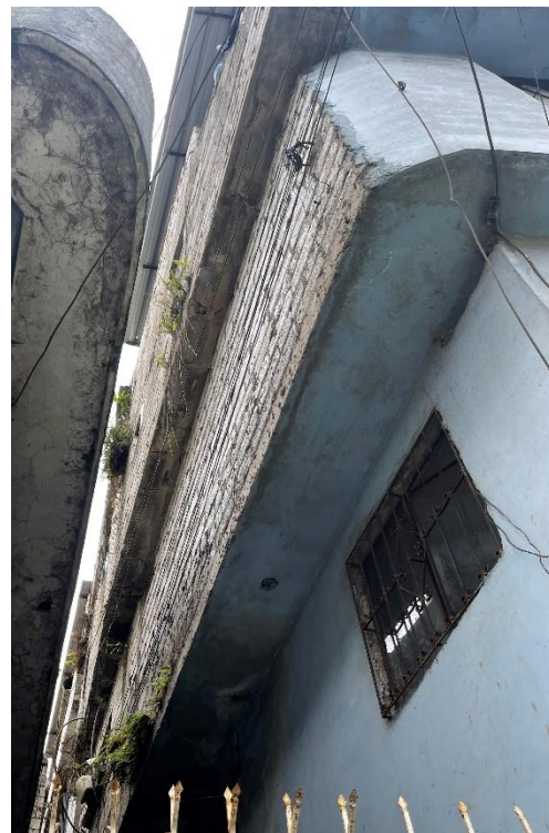
Anexo 67 y 68. Materiales erosionados, con vegetación y moho
