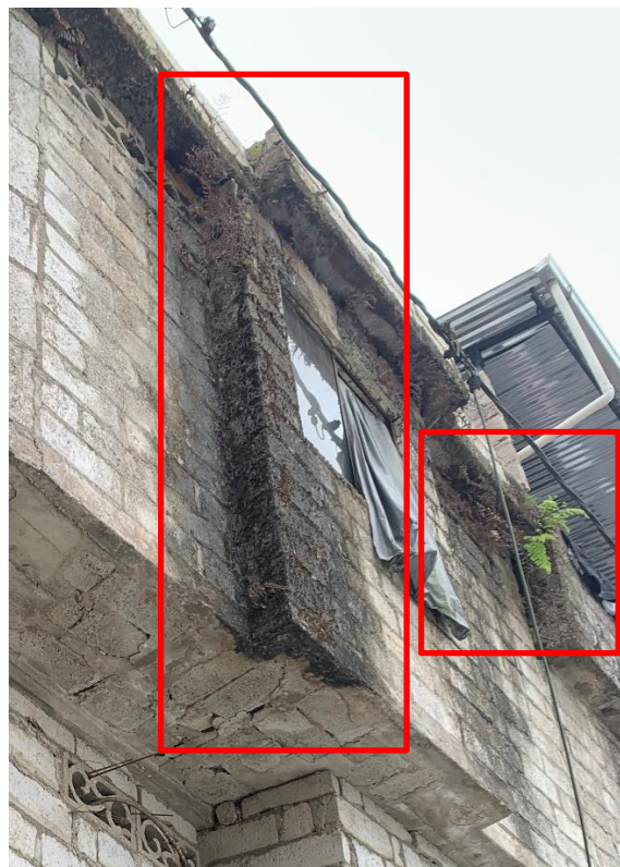
Anexo 13. Presencia de humedad, vegetación y erosión
