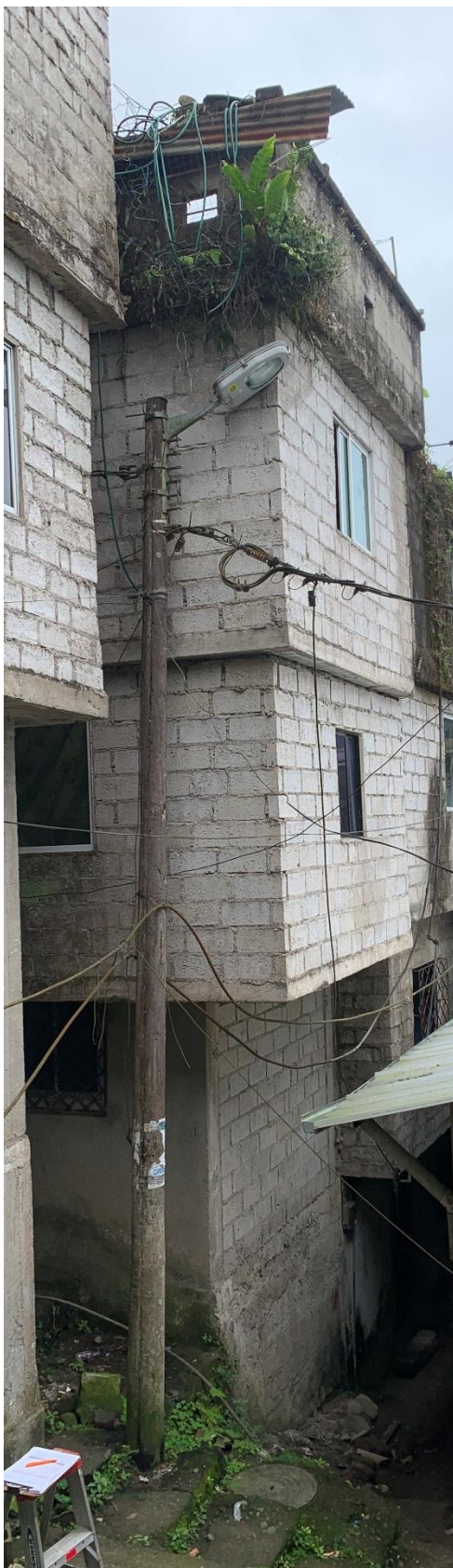
Anexo 34. Erosión de los materiales, humedad, moho y vegetación parásita
