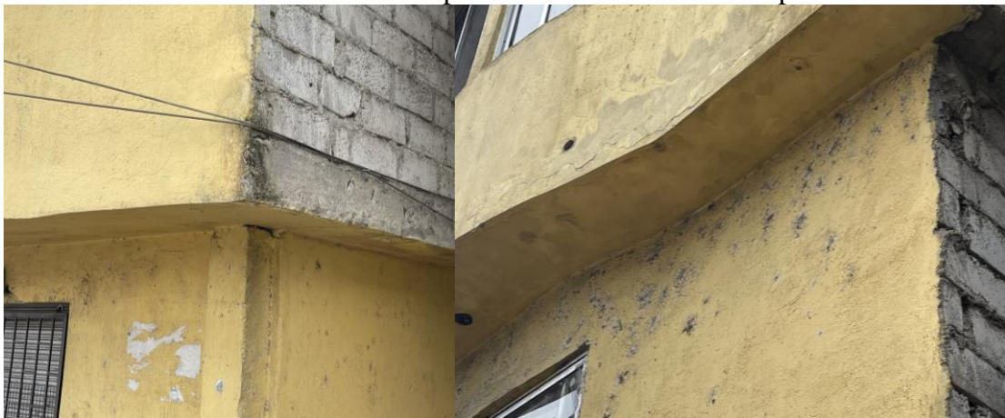
Anexo 57. Erosión de los materiales, humedad y moho
