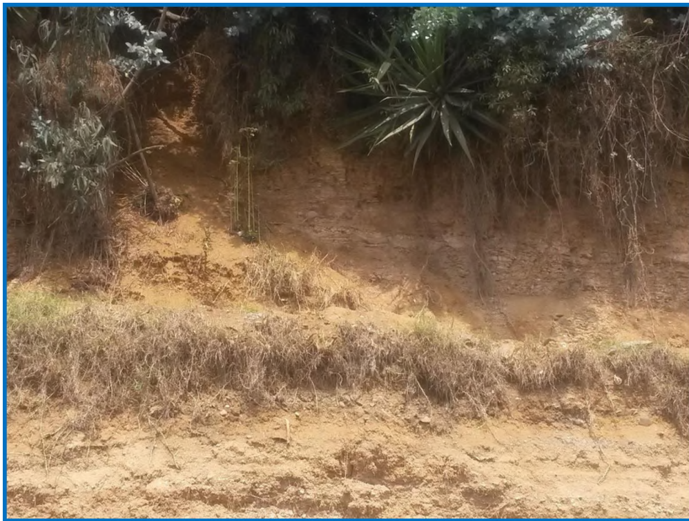
Fotografía 4: Lentes de areniscas que se observan en la vía Monay – Paccha Elaborado: Byron Quezada Fecha: Agosto 2015
