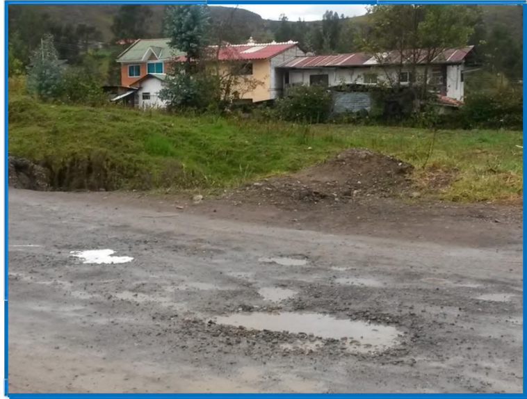
Fotografía 1: Estado actual de la vía producto del movimiento del talud Elaborado: Byron Quezada Fecha: Agosto 2015
