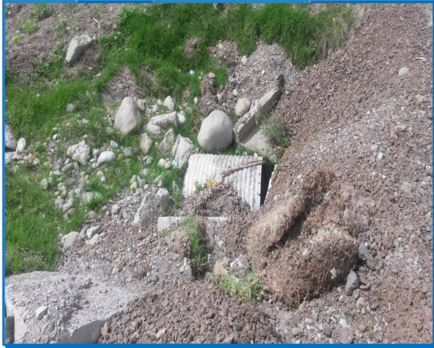
Fotografía 13: Zona donde se produce infiltración Elaborado: Byron Quezada Fecha: Agosto 2015
