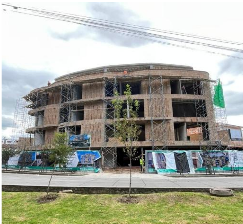
Figura 21: Vista frontal del Edificio Aviano en construcción – Sector Mall del Río. Fuente: Fotografía propia, trabajo de campo (2025).
