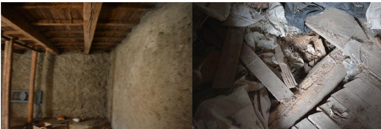
Figura 13: Deterioro en paredes y pisos de la Quinta “La Mercedes”.
