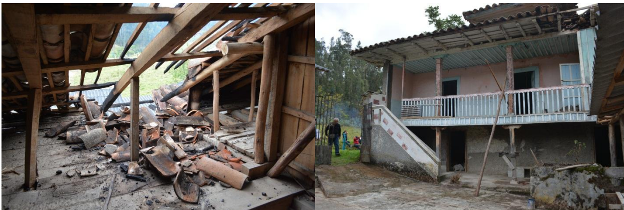
Figura 12: Deterioro en la cubierta de la Quinta “La Mercedes”.
