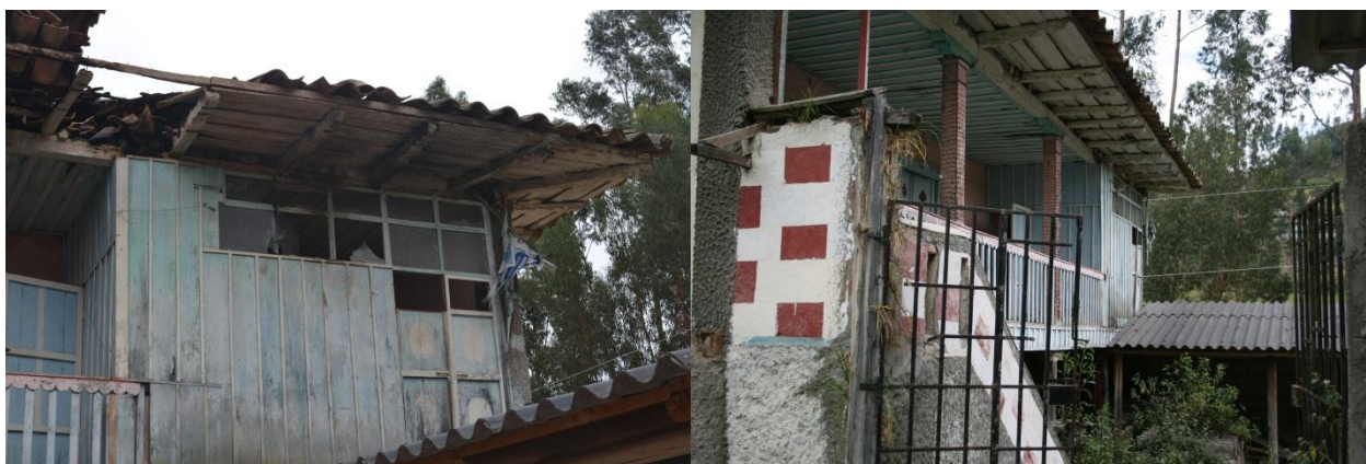
Figura 11: Daños en la Quinta “La Mercedes”.
