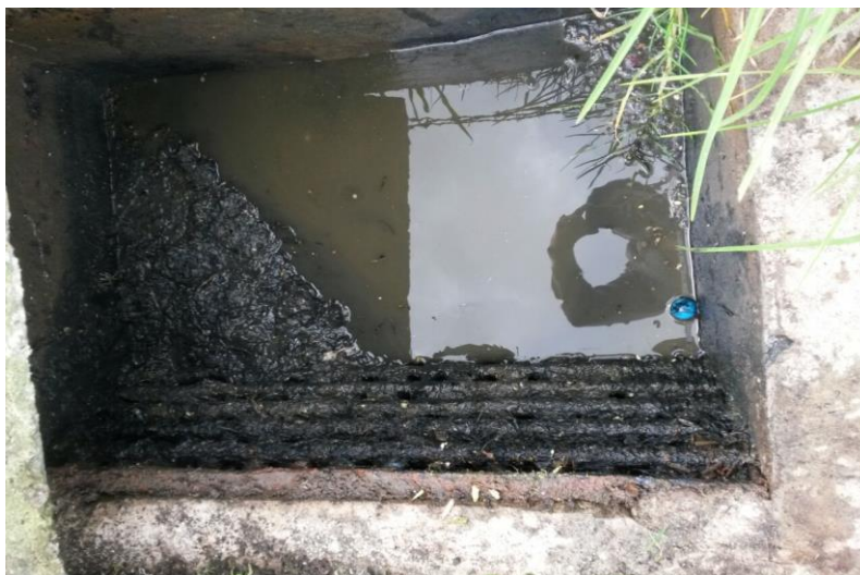
Fotografía 8: Caja de llegada. Fuente: El Autor.
