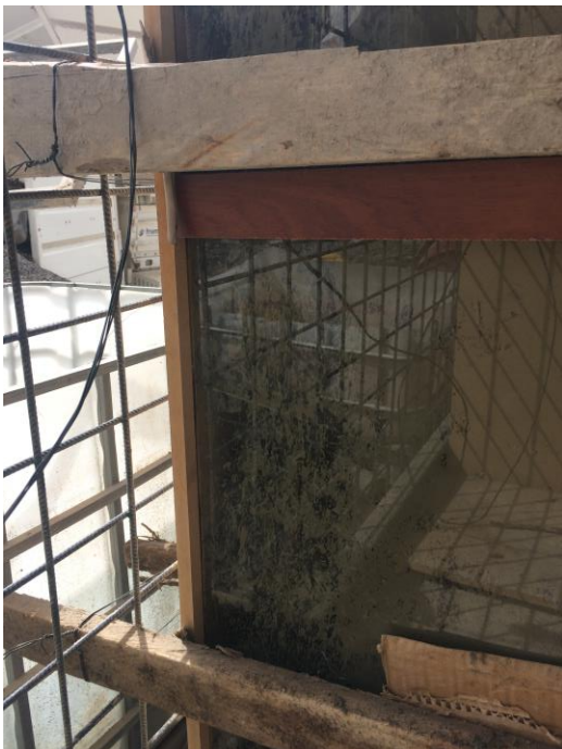
Imagen 70. Hormigón convencional en un muro esbelto sin compactación Fuente: Autor
