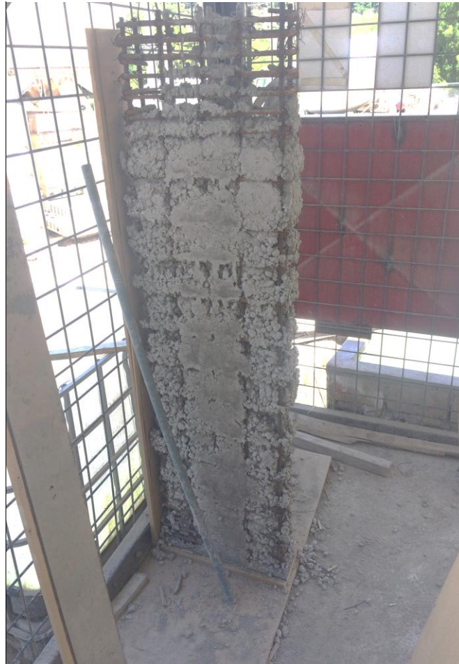
Imagen 29. Muro de hormigón sin compactar Fuente: Autor
