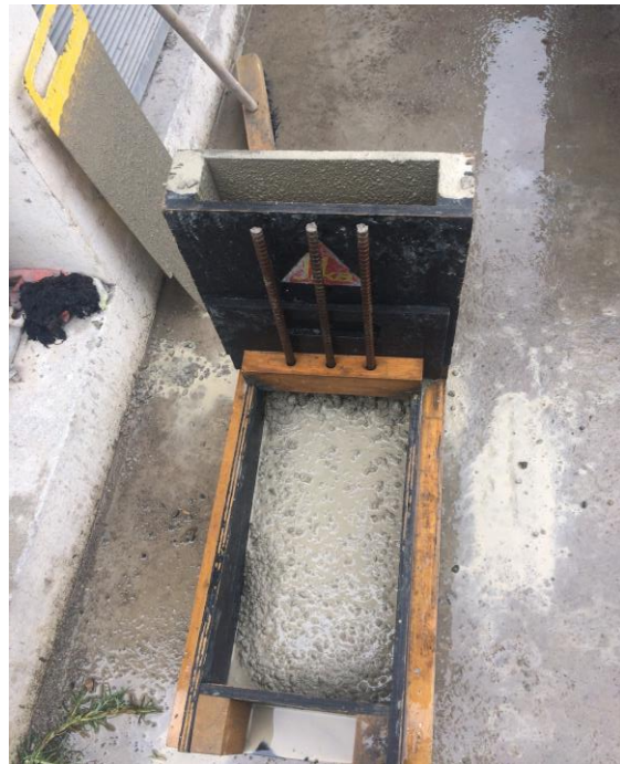
Imagen 59. El hormigón presenta baja fluidez Fuente: Autor
