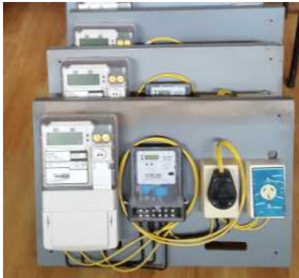
Fig. 9 Tableros de medición Portátil.
