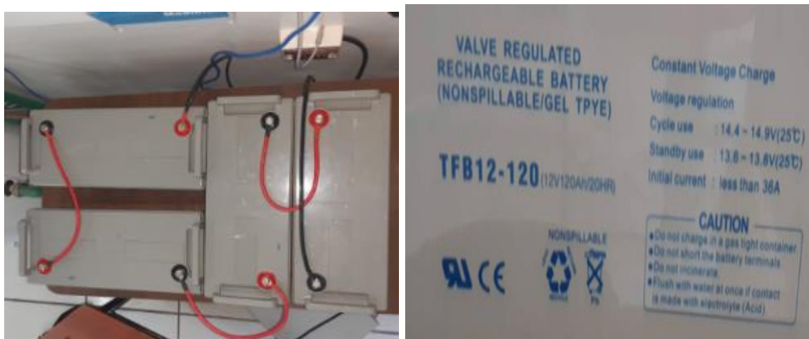
Figura 52. Baterías para el sistema Solar (CER) Fuente: Centro de energías renovables de la universidad católica de cuenca
