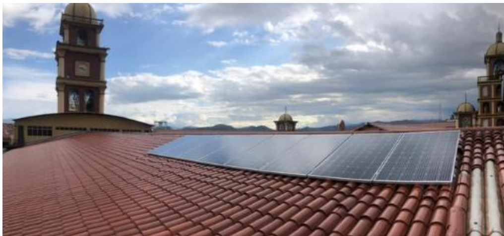
Figura 44. Paneles solares fotovoltaicos (CER) Fuente: Centro de energías renovables de la universidad católica de Cuenca
