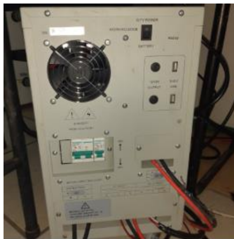
Figura 47. Parte posterior del Inversor SC2KW Fuente: Centro de energías renovables de la universidad católica de cuenca
