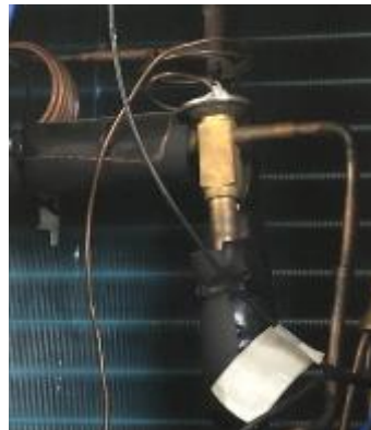
Figura 19. Válvula de expansión de una bomba de calor Fuente: Centro de Energías Renovables universidad católica de Cuenca
