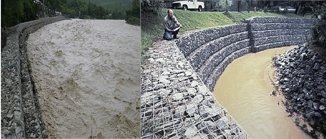
Figura 5.1. Muros de gaviones en ríos.
