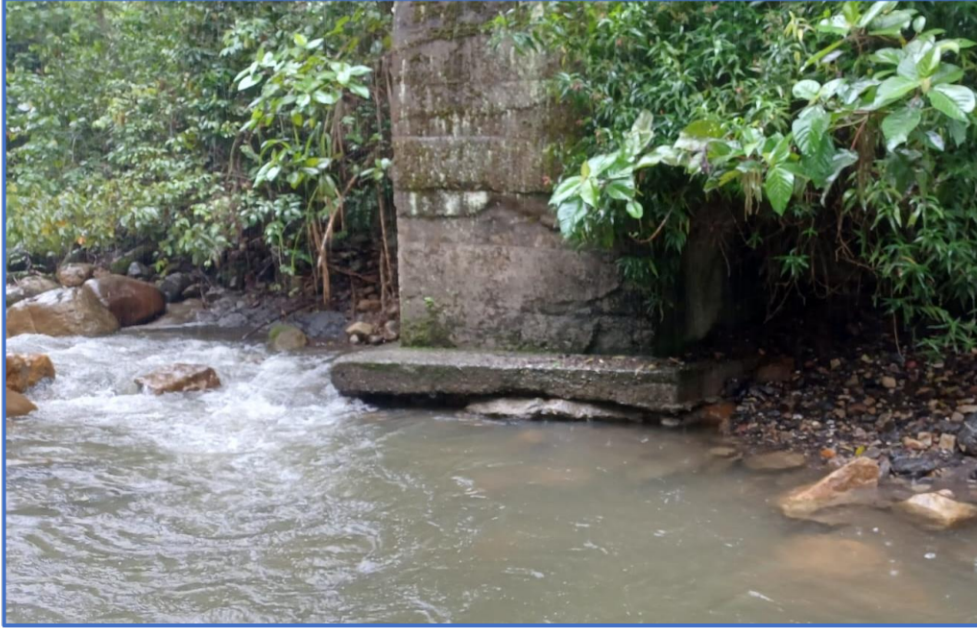
Figura IV. Socavación de estribos paso de agua potable, Rio Yumaza.
