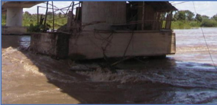
Figura 1.9. Proceso de socavación local.
