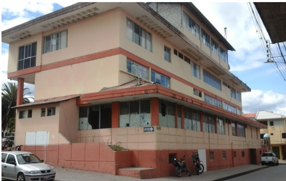
Img. 31 Fachada lateral y posterior deteriorada Fotografías tomadas por: Steve Palacios T. Fuente: Fachadas del Palacios de Santa Isabel
