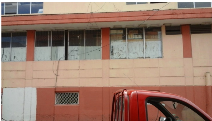
Img. 32 Cableado colgado y visible Fotografías tomadas por: Steve Palacios T.
