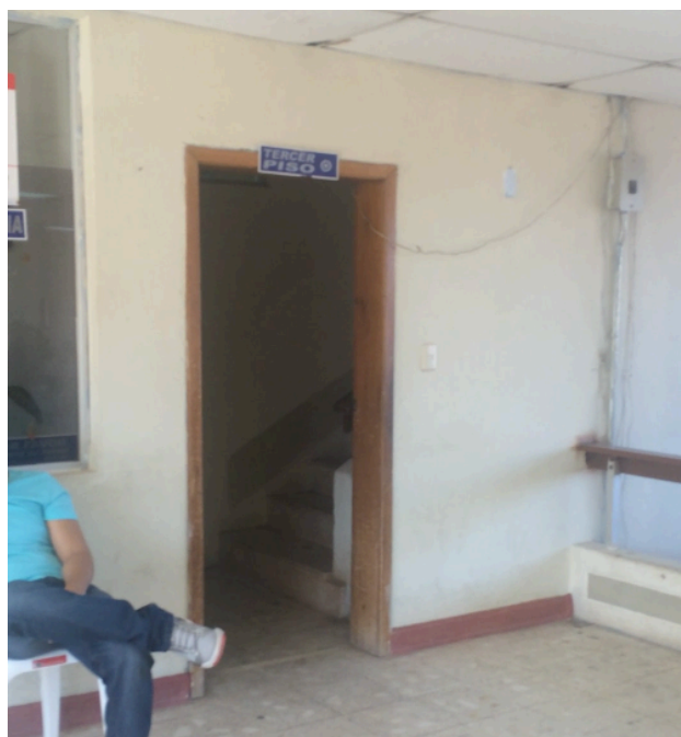
Img. 29 No cumple el modelo de circulación como en los otros pisos
