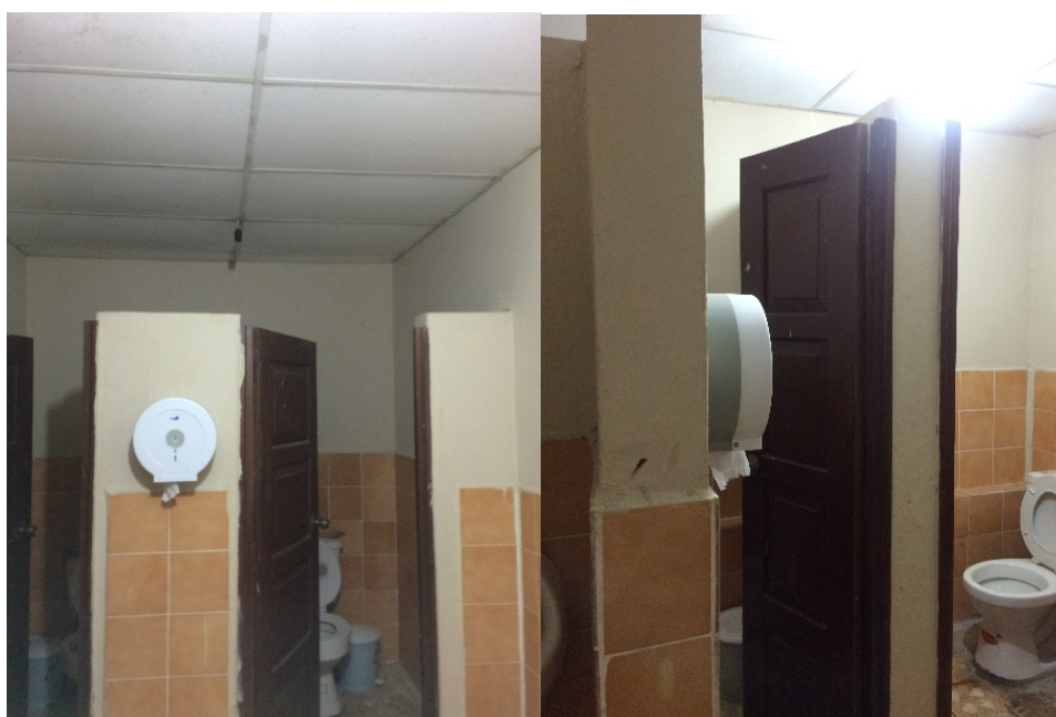
Img. 18 Batería Sanitaria que no se ajusta a las normas para discapacitados
