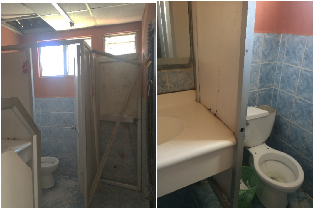
Img. 22 Bateria Sanitaria Pública en pésimo estado Fotografías tomadas por: Steve Palacios T. Fuente: Bateria Sanitaria de la Planta Baja del Palacio Municipal
