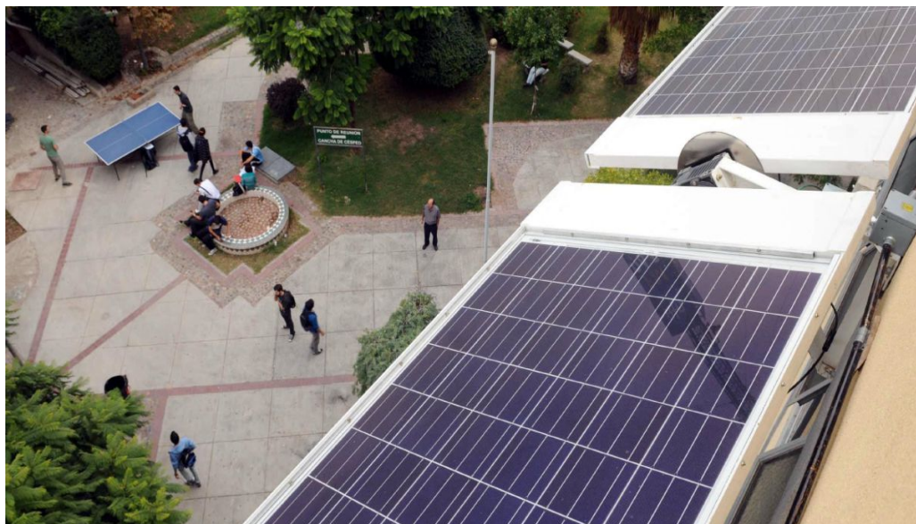
Img. 9 Paneles Solares en la UTN Fuente: (Energia Estrategica, 2017)
