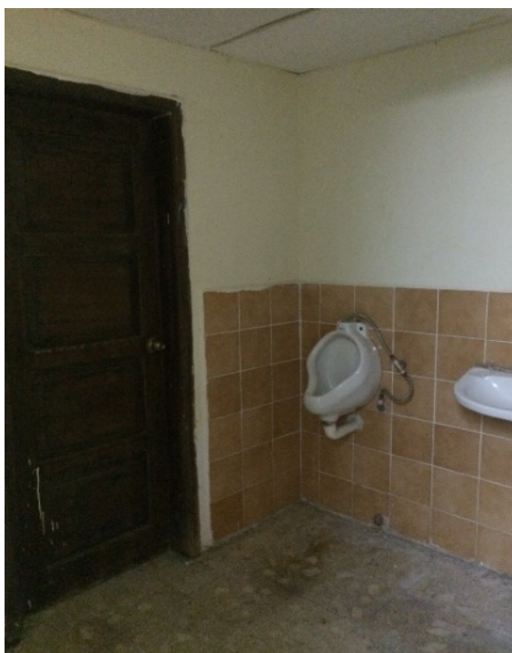
Img. 17 Servicio Higiénico en desuso por falta de piezas sanitarias
