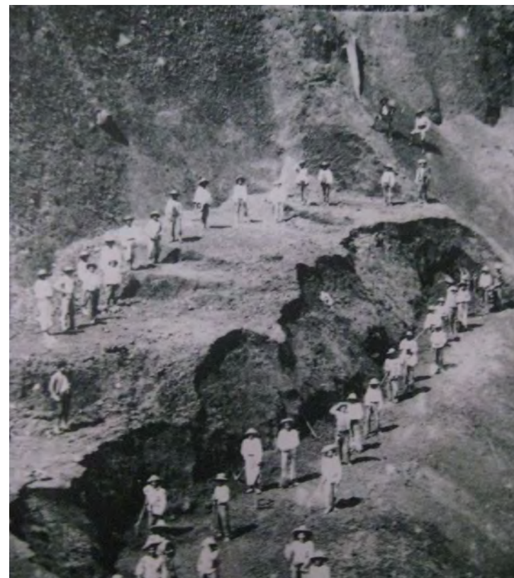
4. Fotografía: Grupo de trabajadores durante la construcción de la Nariz del Diablo.
