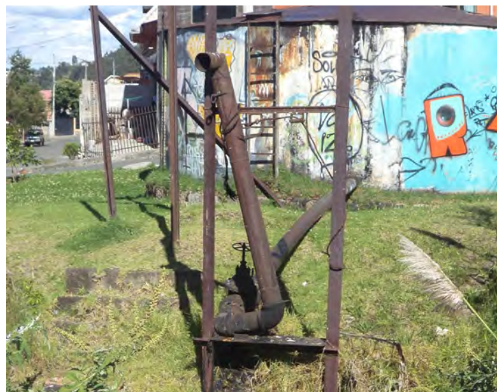
109. Fotografía: Ducto por el cual el aceite se derrama.
