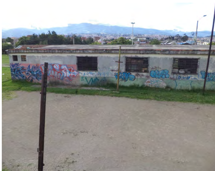
103. Fotografía: Estación deteriorándose, espacio verde erosionado por canchas improvisadas
