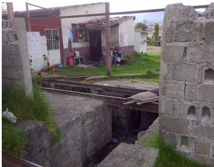
102. Fotografía: Taller y Mecánica deteriorada por el abandono y el paso del tiempo.
