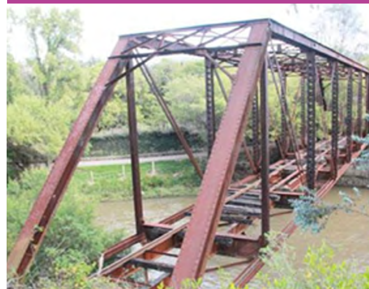
61. Fotografía: Puente sobre el río Cuenca oxidándose por el paso del tiempo.
