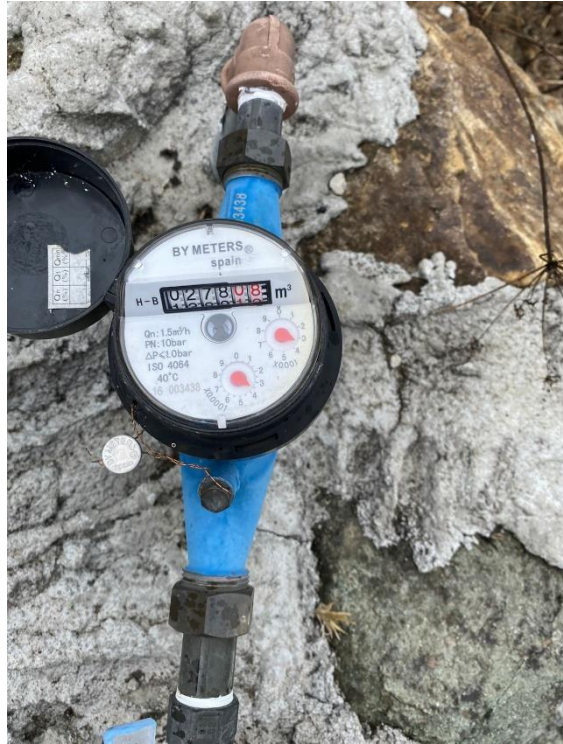
Foto 4: Medidor de agua de donde se obtuvieron datos de caudal
