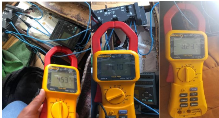
Figura 55. Mediciones corrientes Panel, voltaje Panel, corriente Led (Fuente: Autores)
