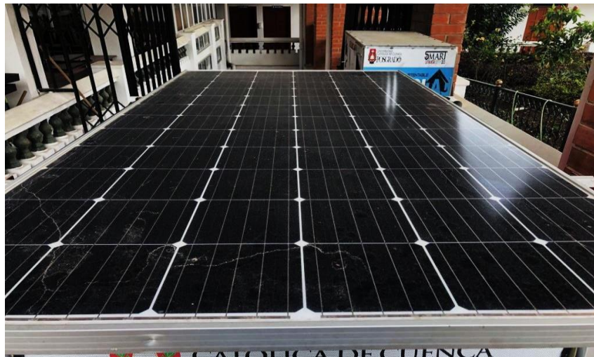
Figura 3 Modulo solar fotovoltaico
