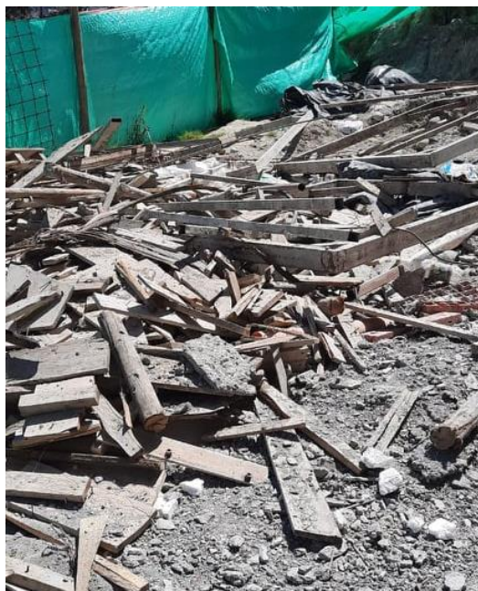
FIGURA 2.12: Desperdicios De Encofrado De Madera
