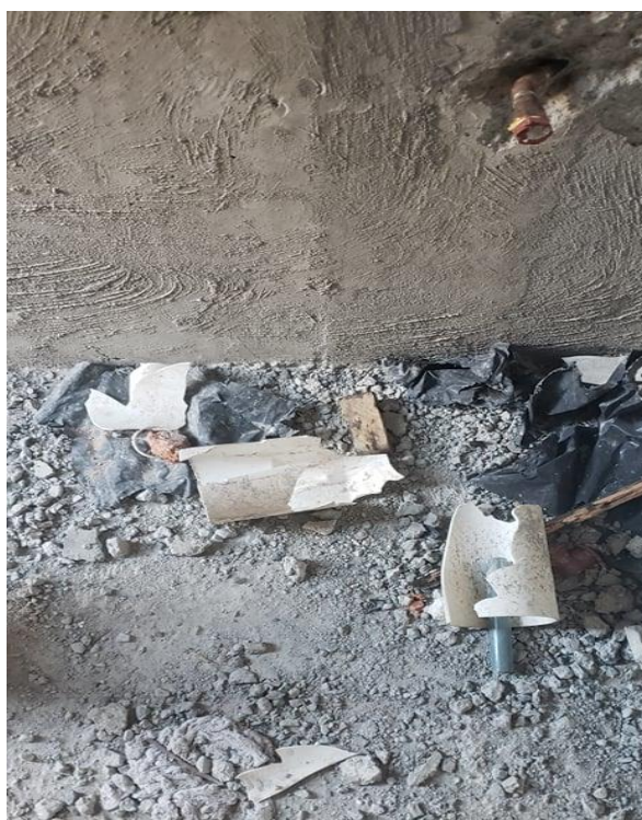
FIGURA 2.42: Desperdicio Tubería de PVC en el Proyecto de Urbanización
