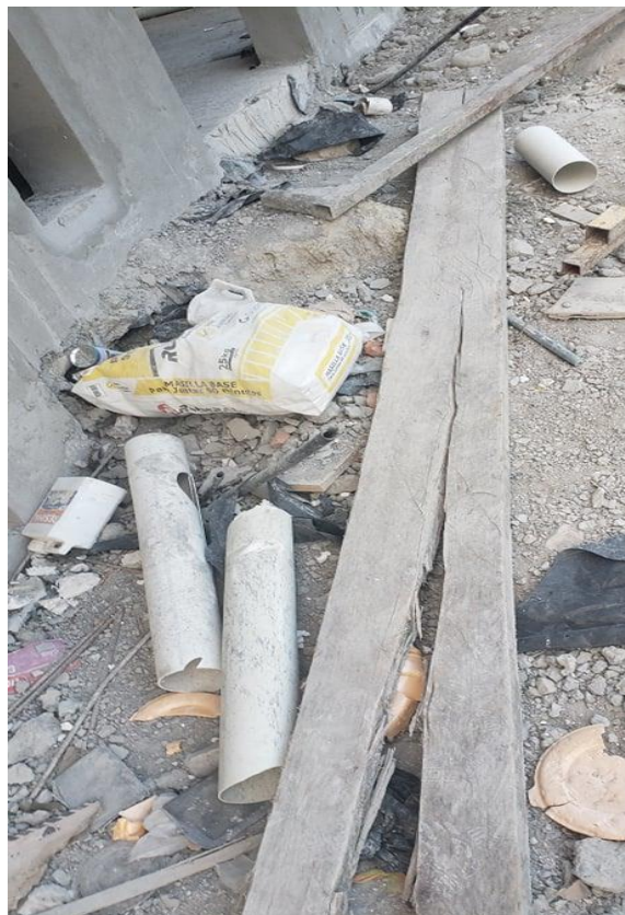
FIGURA 2.41: Desperdicio Tubería de PVC en el Proyecto de Urbanización
