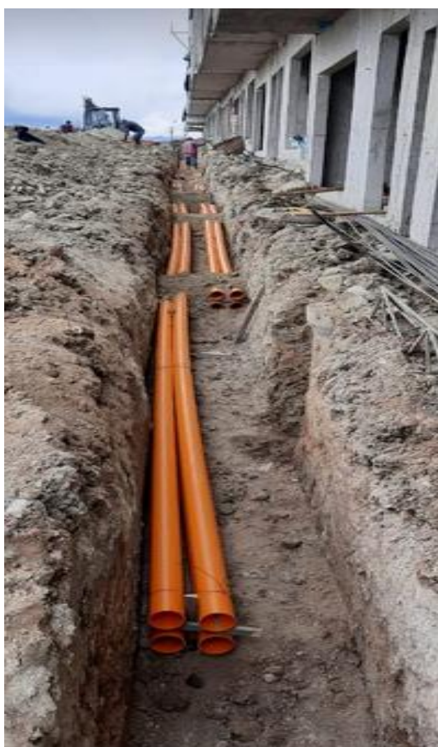
FIGURA 2.66: Tubería PVC de 110mm Pozo Eléctrico
