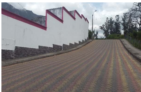
Figura 61 Estado vial de la calle Jaime Roldós.
