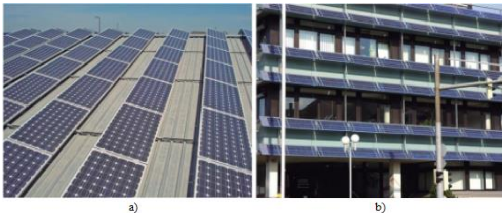
Figura 2.12. Instalación fotovoltaica en a) cubierta y b) fachada
