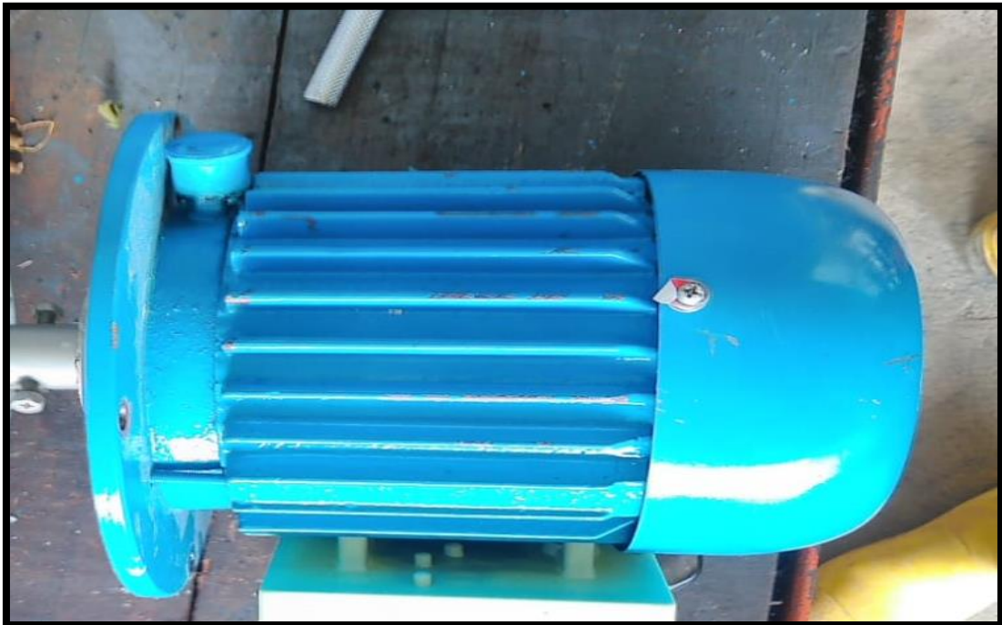
Figura. 55 Generador Fuente: (AUTORES)
