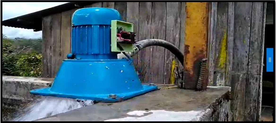
Figura. 56 Operación de la microcentral hidroeléctrica Fuente: (AUTORES)
