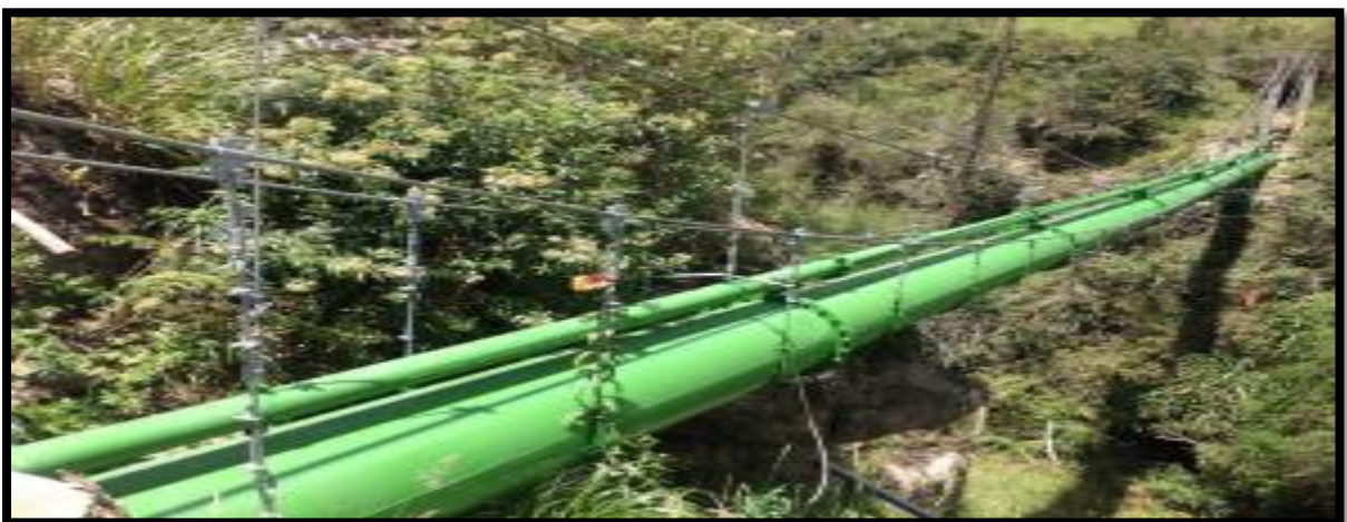
Figura. 14 Canal de conducción de la minicentral hidroeléctrica Gualaceo Fuente: (ELECTRO GENERADORA DEL AUSTRO, s.f.)
