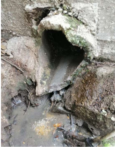
Figura 8. Descarga directa del alcantarillado. Fuente: Elaboración propia.
