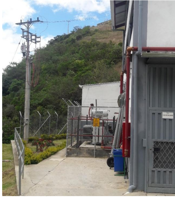
Figura 54. Seccionador tipo cuchilla, conexión con alimentador 1523 y mini central.
