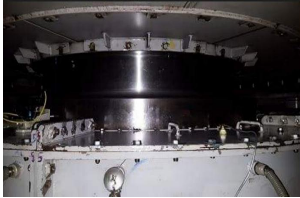
Figura 7. Eje turbina pelton.
