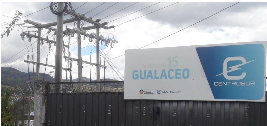
Figura 53. Castillo salida de alimentadores en la Subestación 15.
