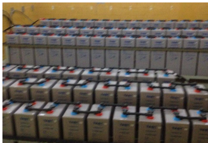
Figura 37. Ejemplo de conexión de baterías.
