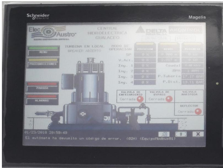
Figura 56. Control y monitoreo de turbina pelton.
