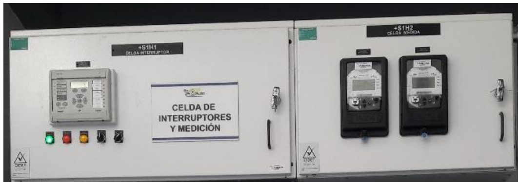
Figura 57. Medición de parámetros eléctricos de la mini central.
