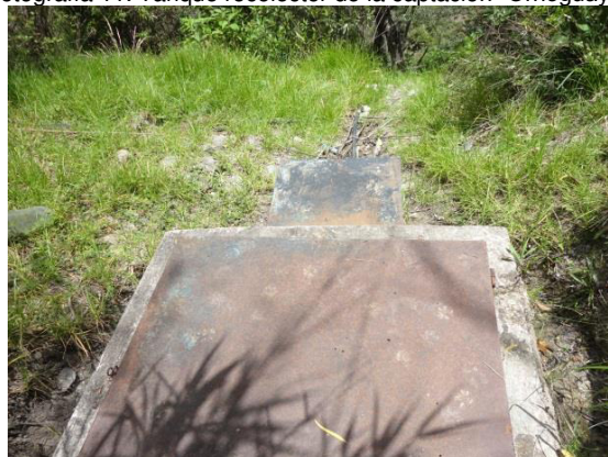
Fotografía 11. Tanque recolector de la captación "Ornoguayco"
