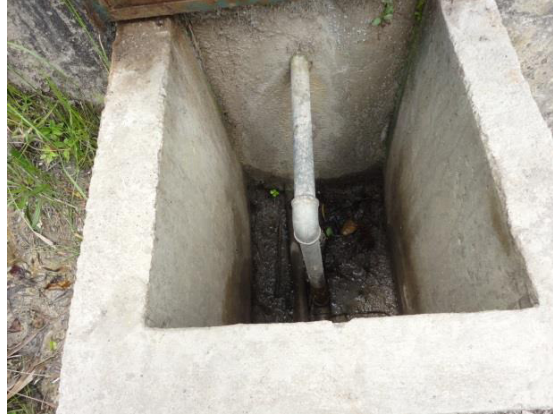
Fotografía 12. Caja de válvulas de la captación "Ornoguayco"
