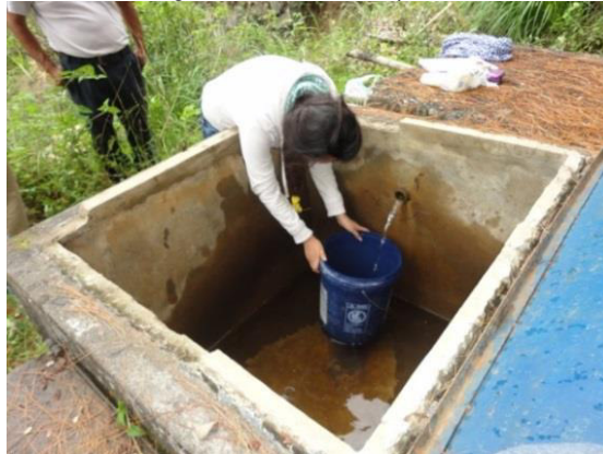
Fotografía 18. Aforo de captaciones
