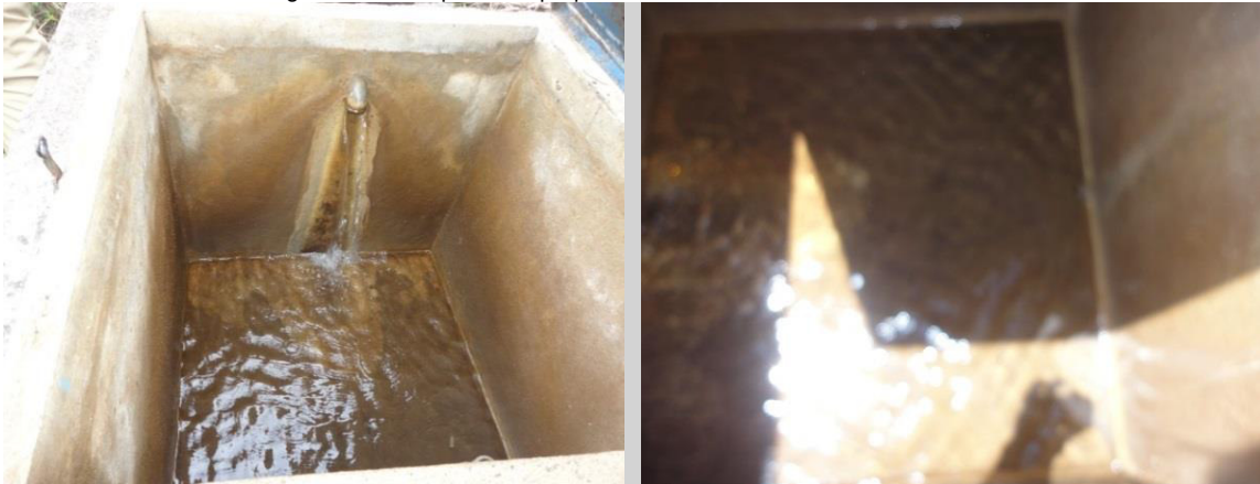
Fotografía 13. Tanques Rompe-presiones existentes en la línea de conducción
