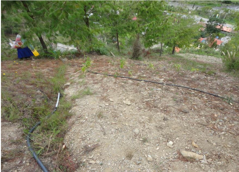
Red de Distribución, en tramos es superficial.
