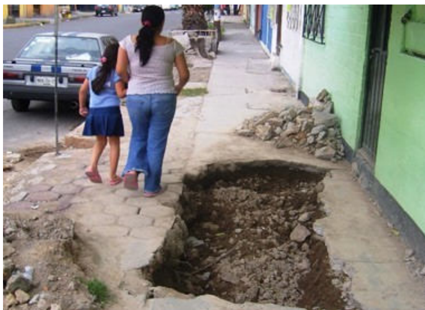
FIGURA 1.20: Aceras peatonales en mal estado. Fuente: (Terán, 1996) https://bit.ly/3LrUrZd
