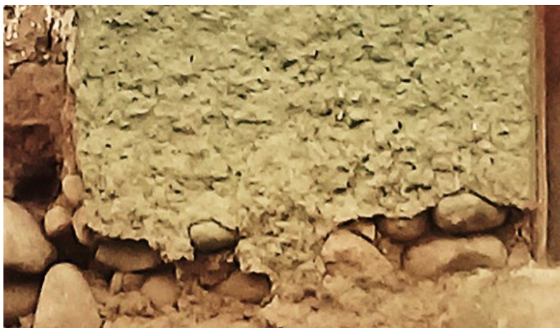
FIGURA 1.3: Lesión física por erosión. Fuente. Francisco Piedra. Año 2018 Elaboración. Francisco Piedra
