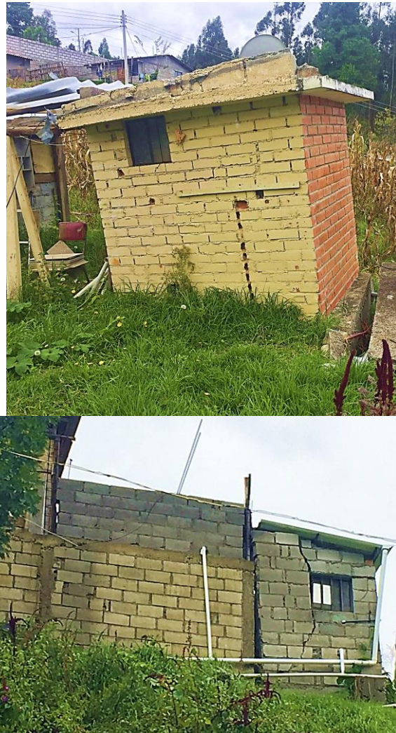
Figura 3-10. Construcciones deterioradas en la parte central de la zona de estudio
