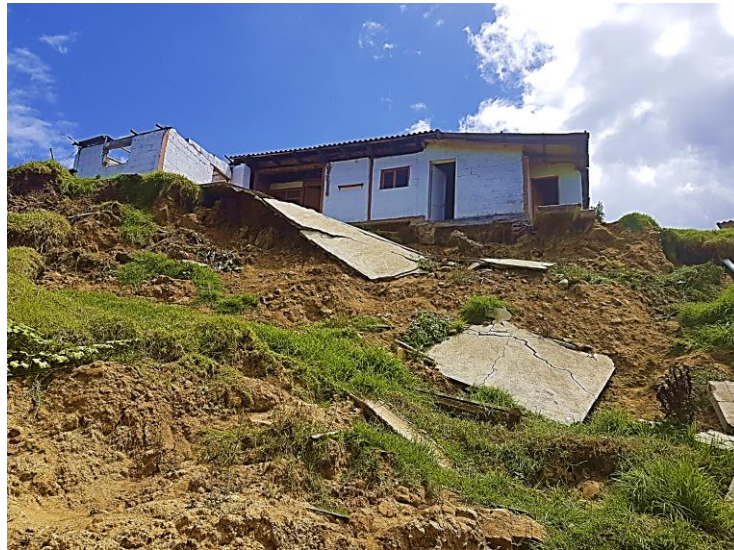
Figura 3-11. Construcción con agrietamiento deshabitada en zona media del deslizamiento
