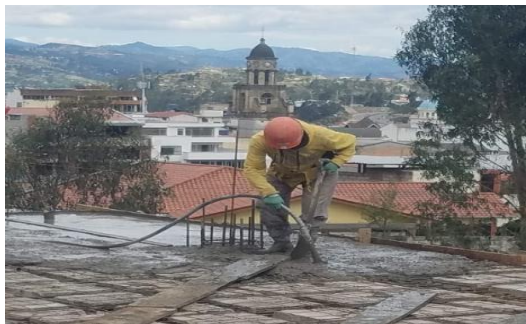
Ilustración 2.6 Compactación de hormigón en una losa con el uso de un vibrador.
