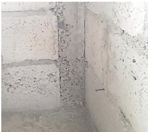
Ilustración 4.6 Segregación del hormigón
