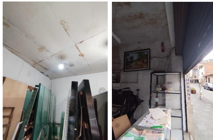
Figura 77. Problemas de planta baja.
