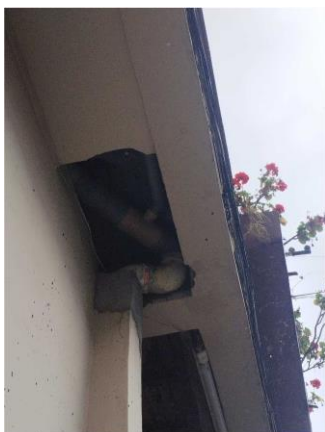
Tuberías al aire libre
