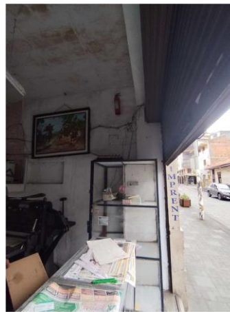
Cielo raso con moho
