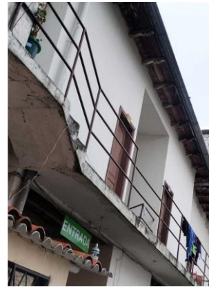
Estructura con grietas y sin mantenimiento
