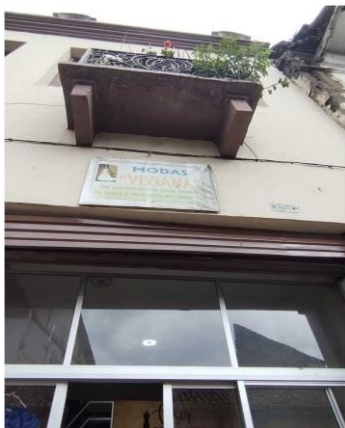
Balcón con humedad
