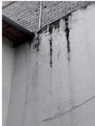
Paredes con moho
