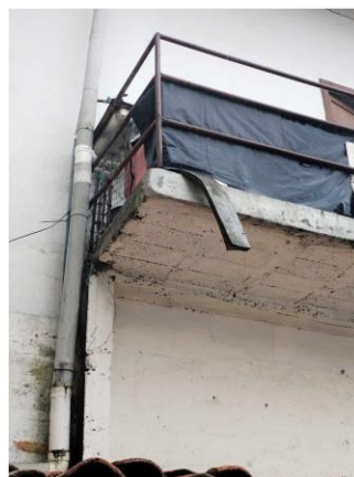
Pasillos en mal estado
