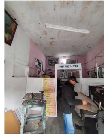
Cielo raso despintado
