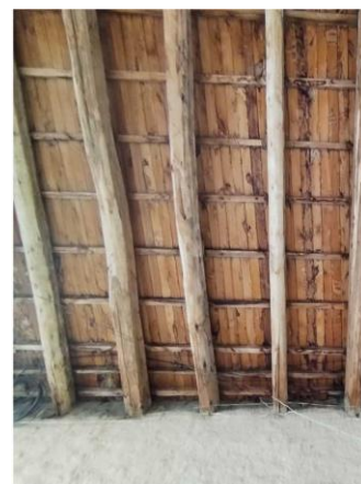
Estructura de madera en mal estado
