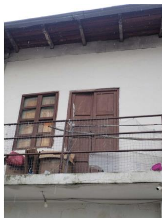
Puertas, ventanas y barandal en mal estado
