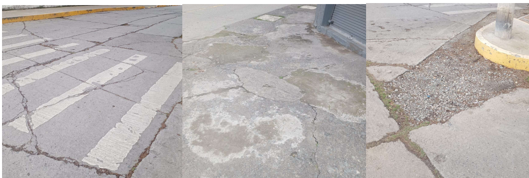
Figura 41: Calles en mal estado
