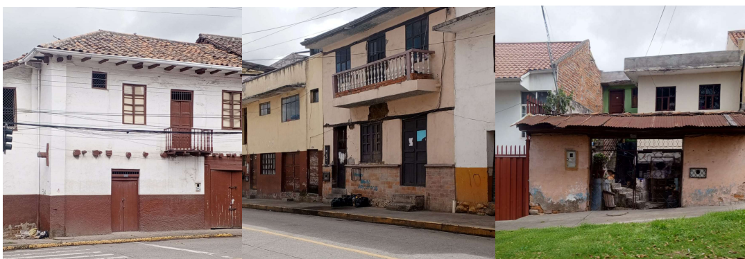
Figura 42: Viviendas en mal estado
