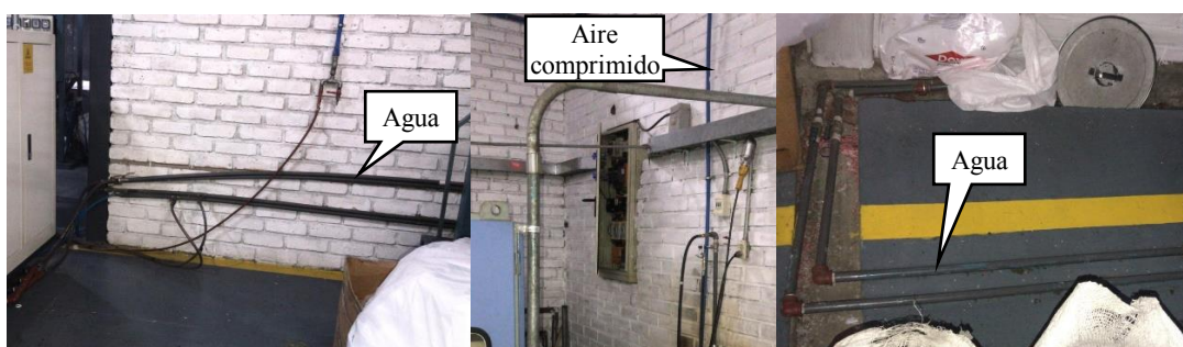
Gráfico 27: Tuberías de agua y aire comprimido señalizados
