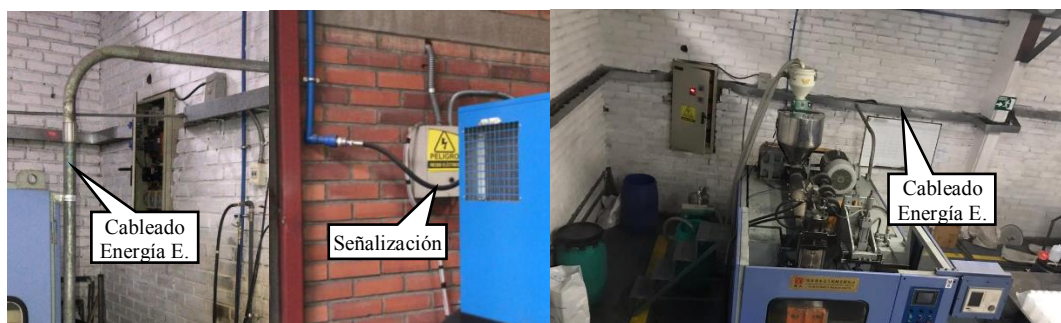
Gráfico 29: Señalización del cableado eléctrico
