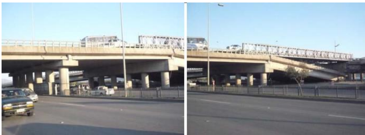
Ilustración 1 Puente en sismo de Chile (Aguiar, 2021)
