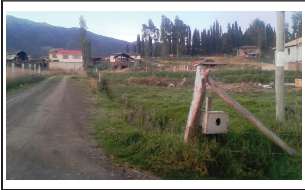
Foto. 82. Medidores de agua potable - San Mateo de la Cerámica.
