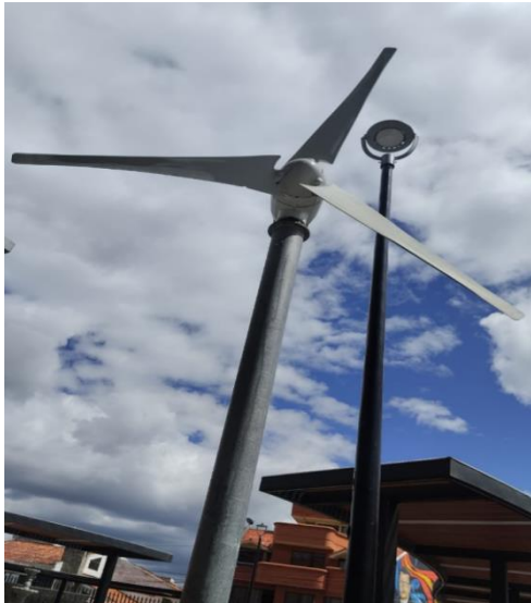
Figura 22. Aerogenerador instalado en la Unidad Académica de Ingeniería, Industria y Construcción. Fuente. Autores.
