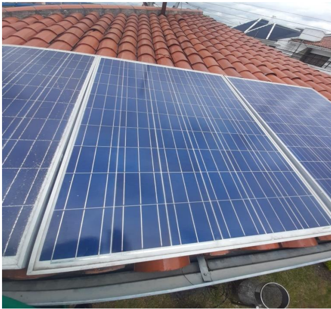
Figura 20. Panel solar policristalino. Fuente. Autores
