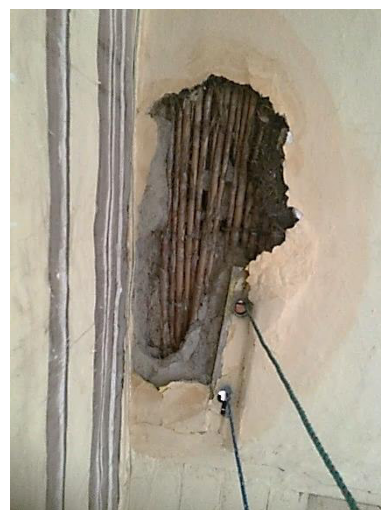
Fig. 40. Deterioro de cielo raso
