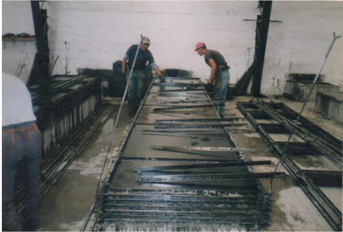
Fotografía 5.- Preparación de los moldes de acero para la fundición de los paneles de hormigón.
