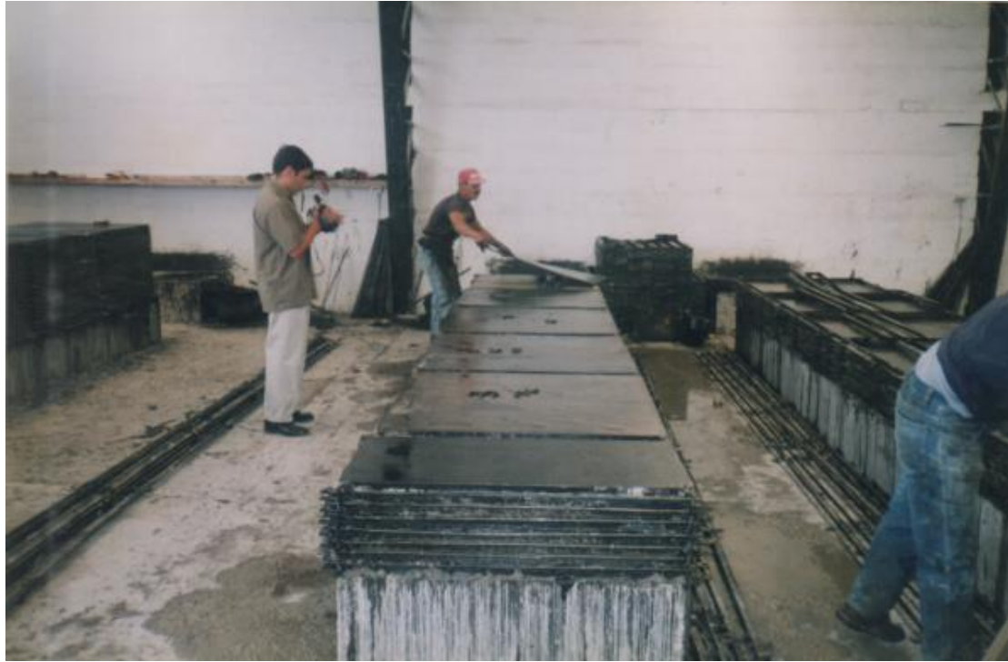
Fotografía 7.- Los moldes con las pasta de hormigón son cubiertos para su fraguado.
