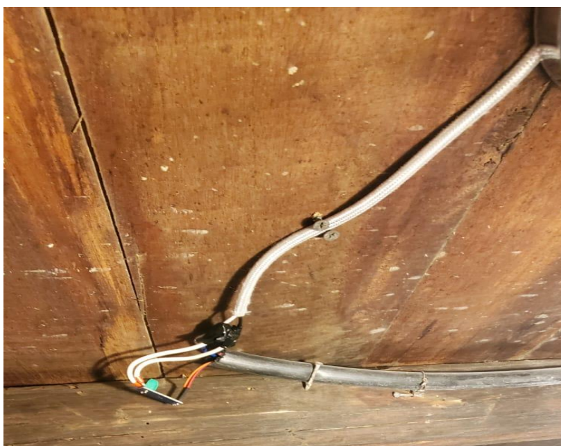
Figura 37 Colocación de sensores
