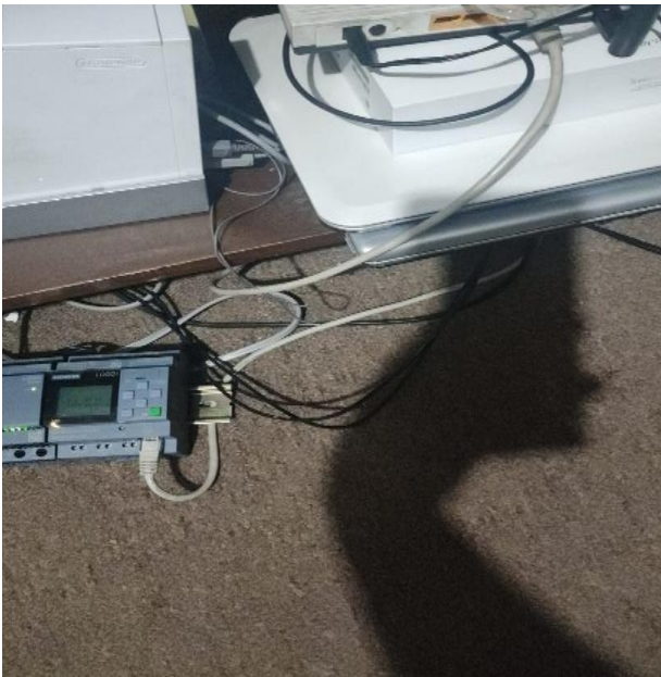
Conexión de Router a PLC
