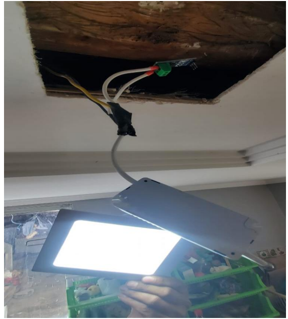
Colocacion de sensores en cocina
