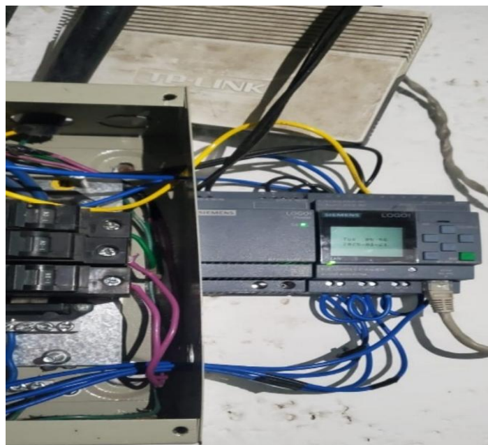
Figura 36 Conexión del PLC al tablero de distribución
