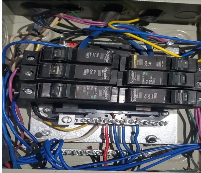
Figura 34 Tablero de control de la vivienda
