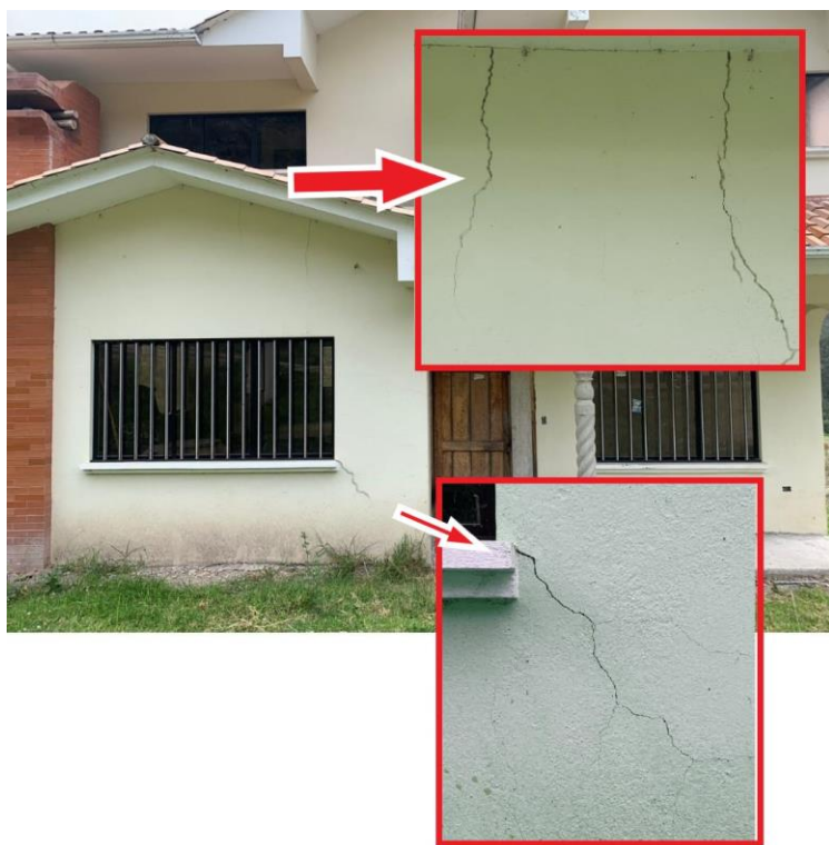
Figure 13. Casa 17. Detalle de fisuras en vivienda esquematizada.
