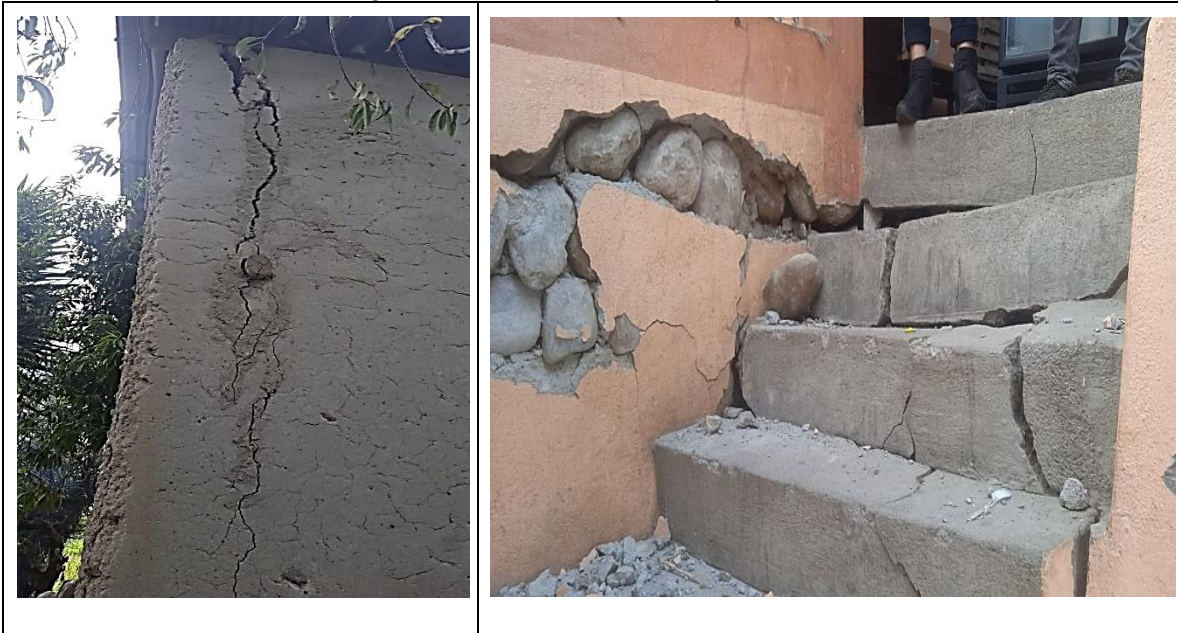
Figura 7. Casa 11. Daños en muros y escaleras.
