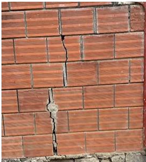
Figura 21. Pared de la vivienda 13
