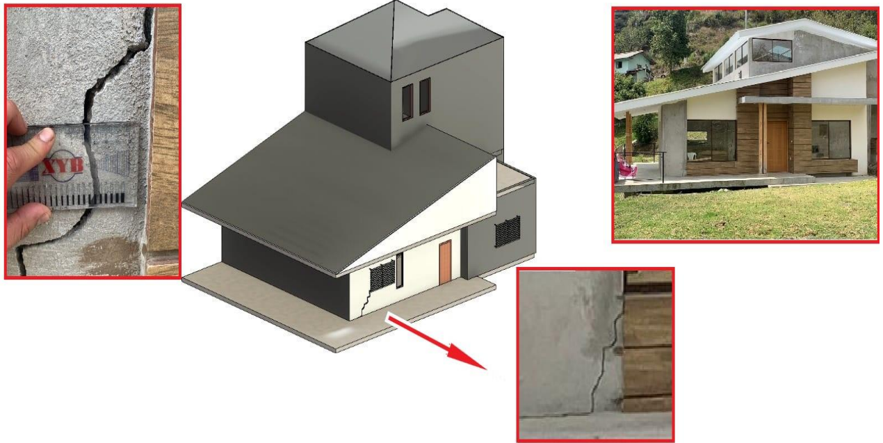
Figura 10. Casa 14. Detalle de fisuras en vivienda nueva.
