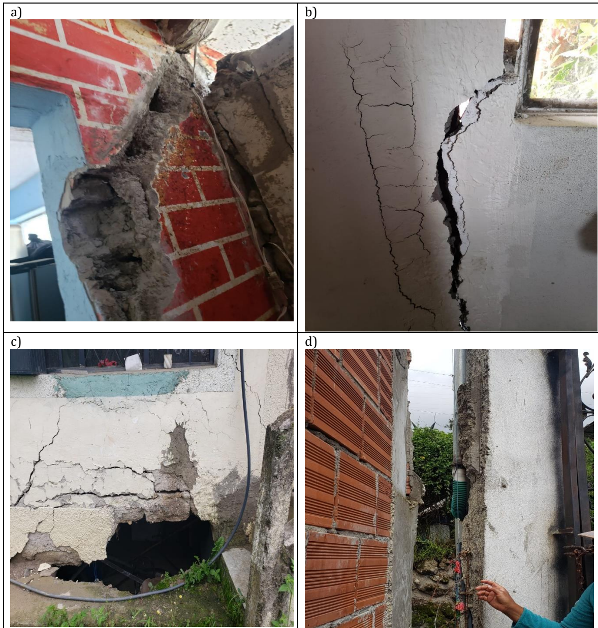
Figura 15. a) Falla a tracción originada por ausencia de columna confinante en la esquina de los muros, b) La falta de una columna de amarre ha generado una falla por tracción diagonal en la fachada, resultando en grietas severas y un significativo desplazamiento de las piezas rotas de esa pared, c) Colapso de parte del entrepiso y el muro del nivel de suelo, d) Desprendimiento total de una columna que sostiene una puerta metálica, se evidencio ausencia de anclajes.
