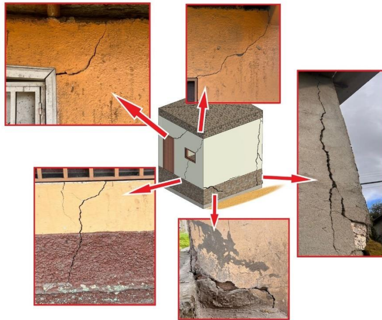
Figura 6. Casa 9. Detalle de fisuras en bodega.
