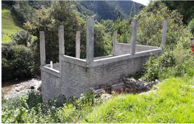
Fig. 39 Tanque de almacenamiento
