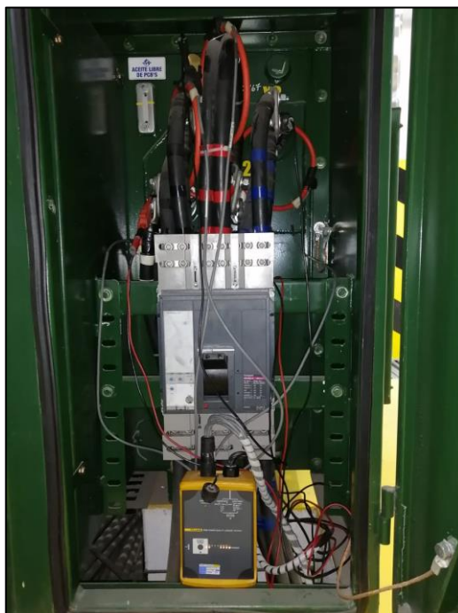
Fotografía 11. Vista general de instalación de equipo de análisis FLUKE 1744 Fuente: (Salinas Quezada, 2019)
