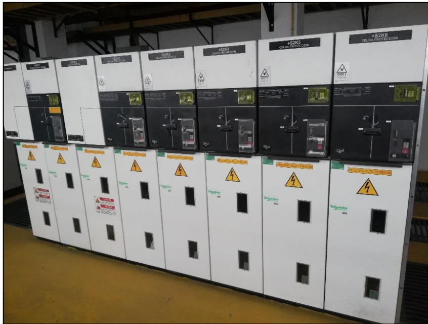
Fotografía 4. Celdas de salida a diferentes transformadores Fuente: (Salinas Quezada, 2019)
