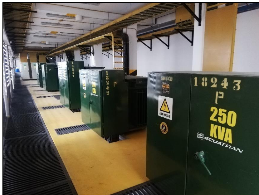
Fotografía 5. Vista de transformadores instalados en cámara de transformación Fuente: (Salinas Quezada, 2019)
