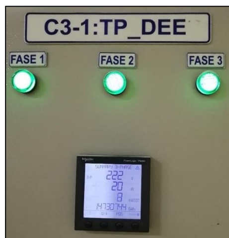
Fotografía 7. Tablero C3-1:TP_DEE, energizado a través de transformador 3 Fuente: (Salinas Quezada, 2019)
