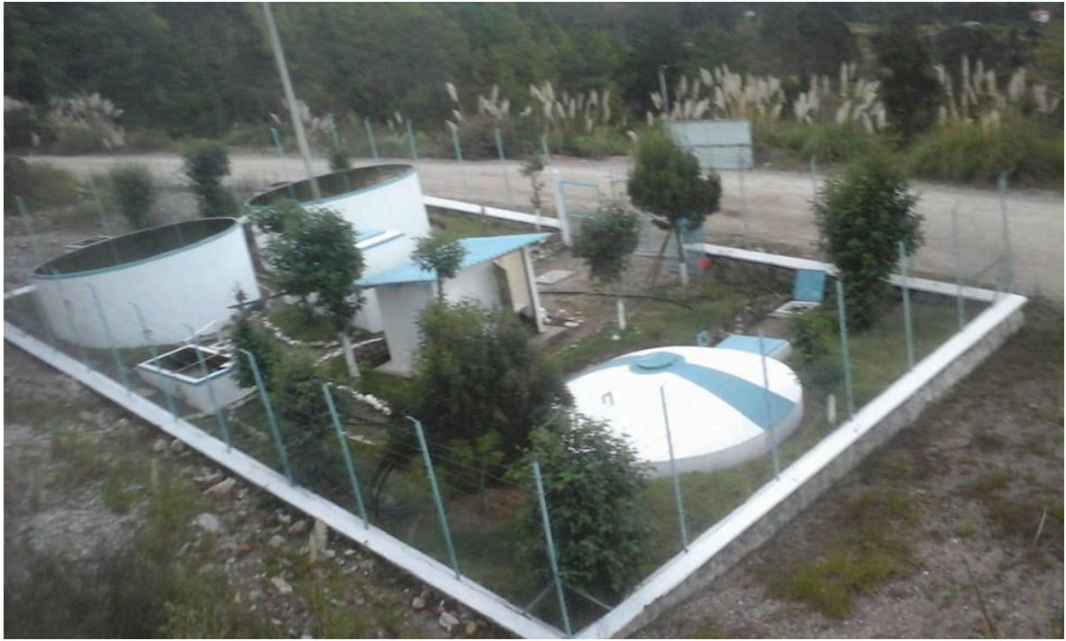
Figura 30 Planta de tratamiento actual de la comunidad de Quimzhi Fuente: Autor
