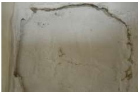
Fotografía N° 69,70 y 71: Catas de la capa pictórica de los muros exteriores.
