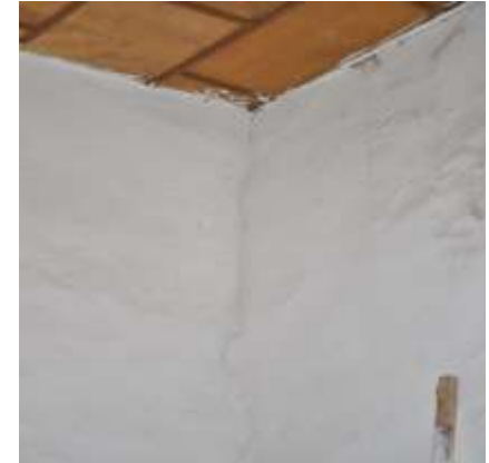
Fotografía N° 23: Fisuras en la unión en el ambiente EG23.
