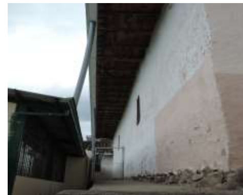
Fotografía N° 28: Erosión Basal – Fachada lateral derecha.
