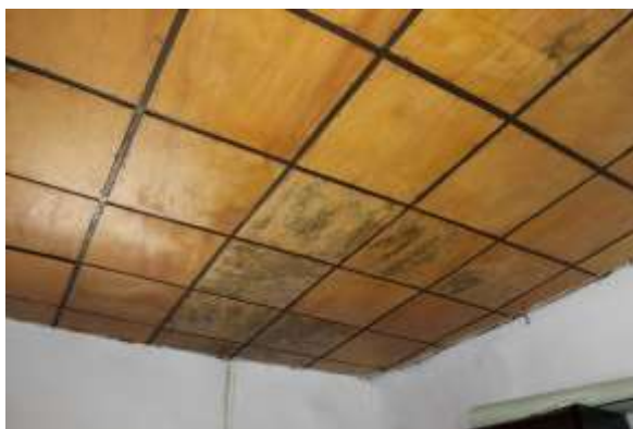
Fotografía N° 52: Presencia de humedad – ambiente AC910.
