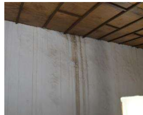
Fotografía N° 58: Presencia de humedad por la filtración de agua.
