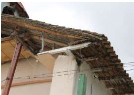
Fotografía N° 26: Cabezal de muro afectado por la erosión.
