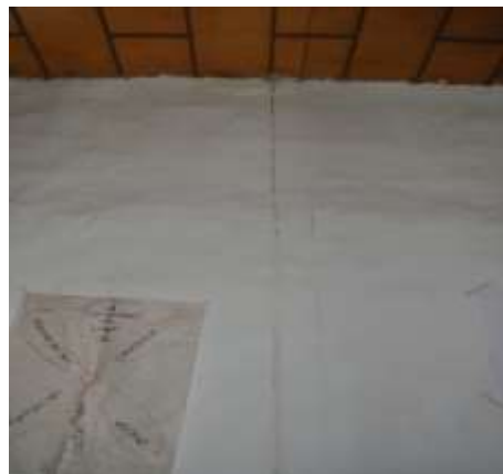
Fotografía N° 17, 18, 19 y 20: Presencia de eflorescencias.
