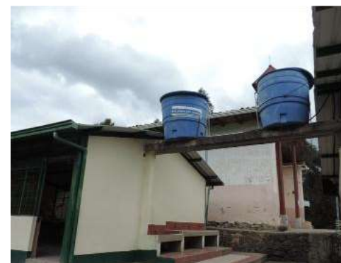
Fotografía N° 111: Tanques de reserva entre los bloques dos y tres.
