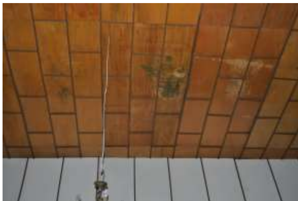
Fotografía N° 51: Presencia de Humedad y xilófonos
