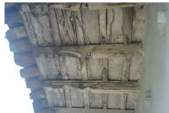
Fotografía N° 41: Alero de las naves – mal estado.
