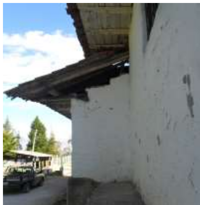
Fotografía N° 25: Pared Inconclusa – ineficiencia constructiva.
