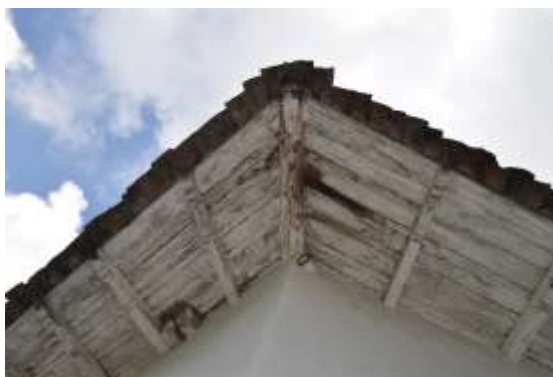
Fotografía N° 39: Alero del presbiterio – mal estado.
