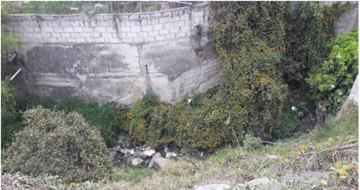
FIGURA 3.32: Falta de Saneamiento en el sector - Fuente: Autor.
