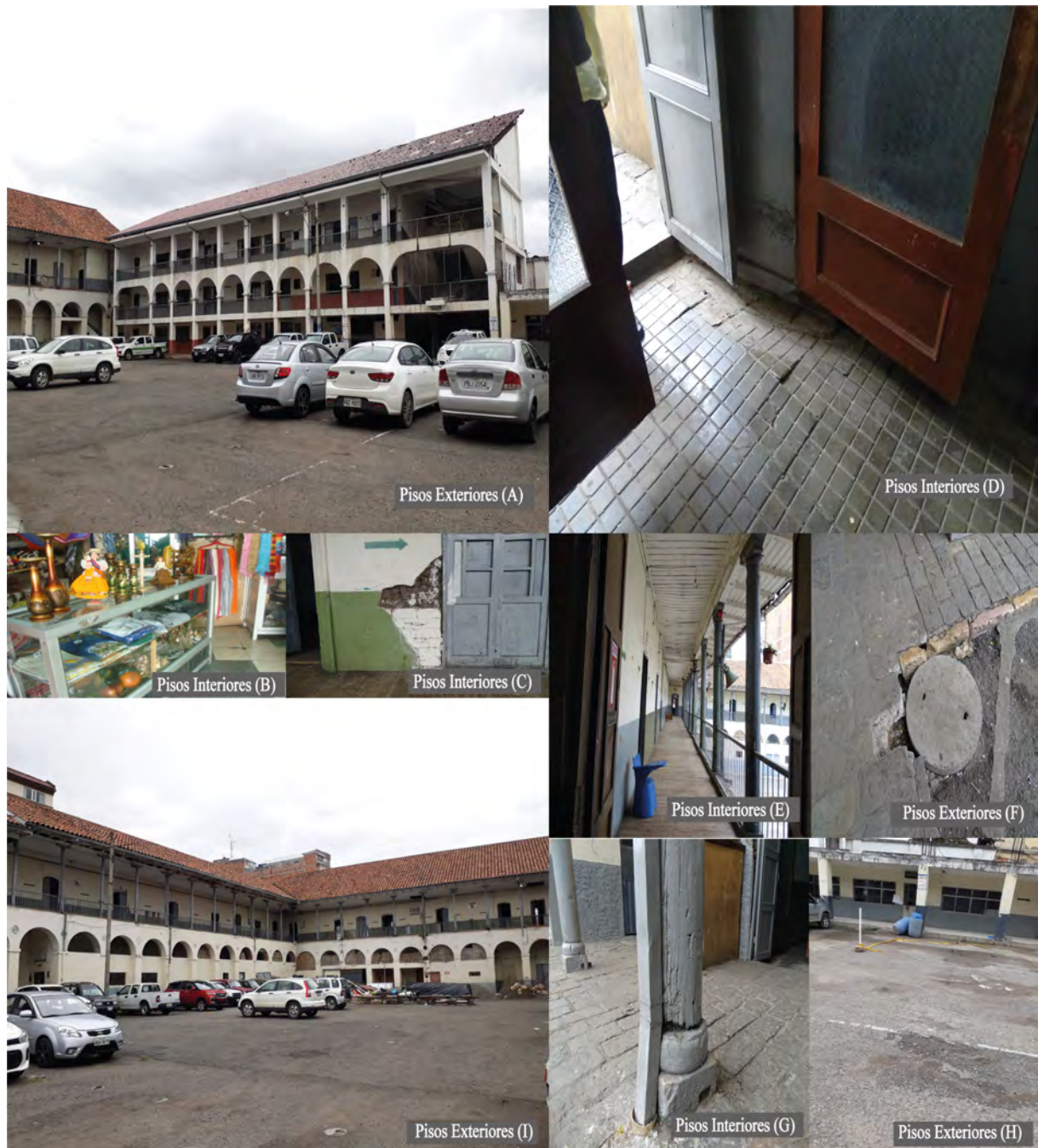
FIGURA 2.11: Imágenes del estado de pisos. Fuente: Espinoza (2018). Elaboración: propia.
