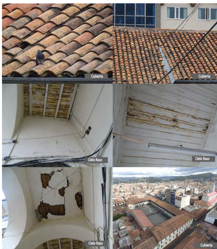
FIGURA 2.17: Imágenes del estado actual de cielo raso y cubierta. Fuente: Espinoza (2018). Elaboración: propia.
