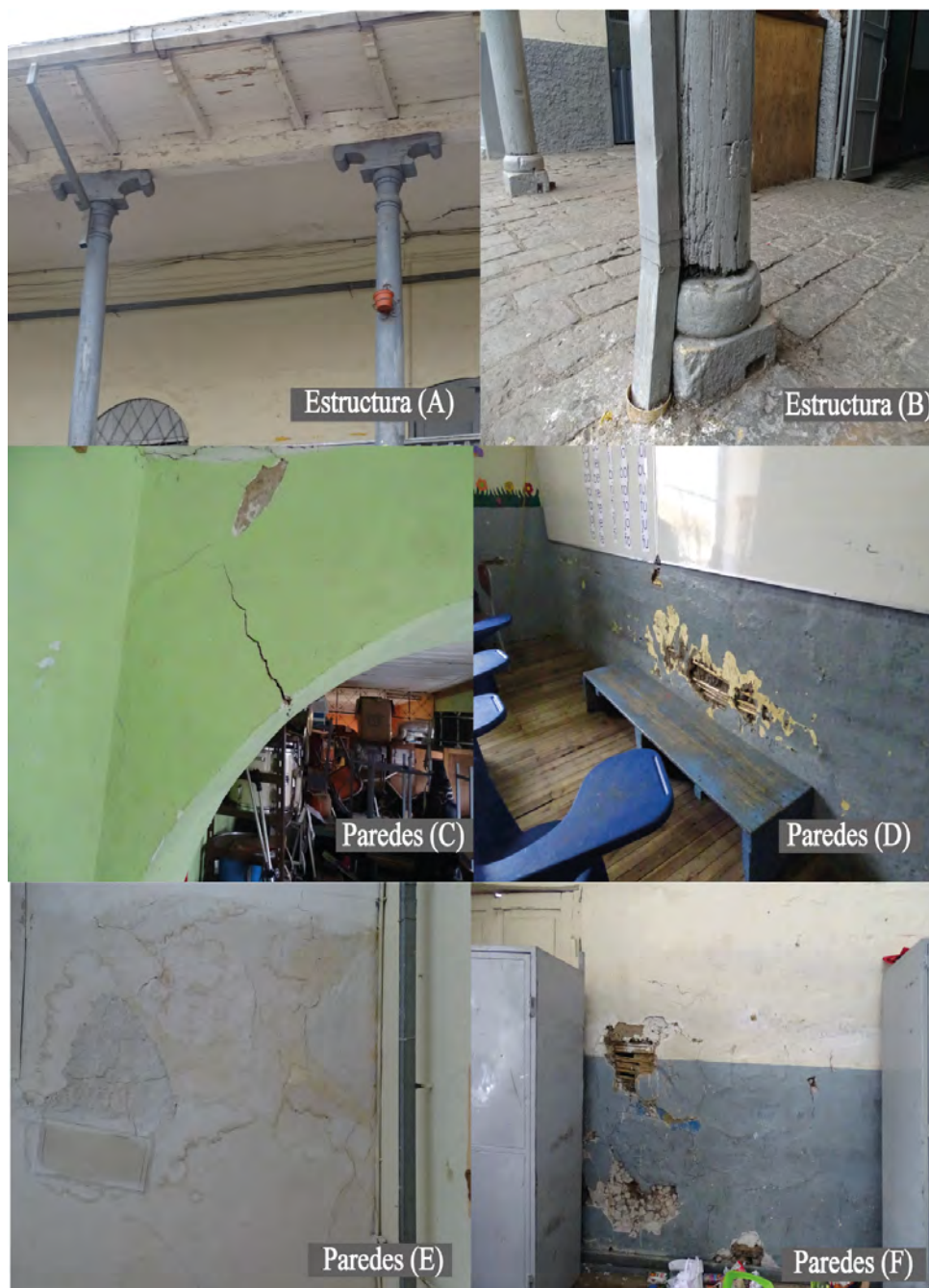
FIGURA 2.14: Imágenes del estado de paredes y muros. Fuente: Espinoza (2018). Elaboración: propia.
