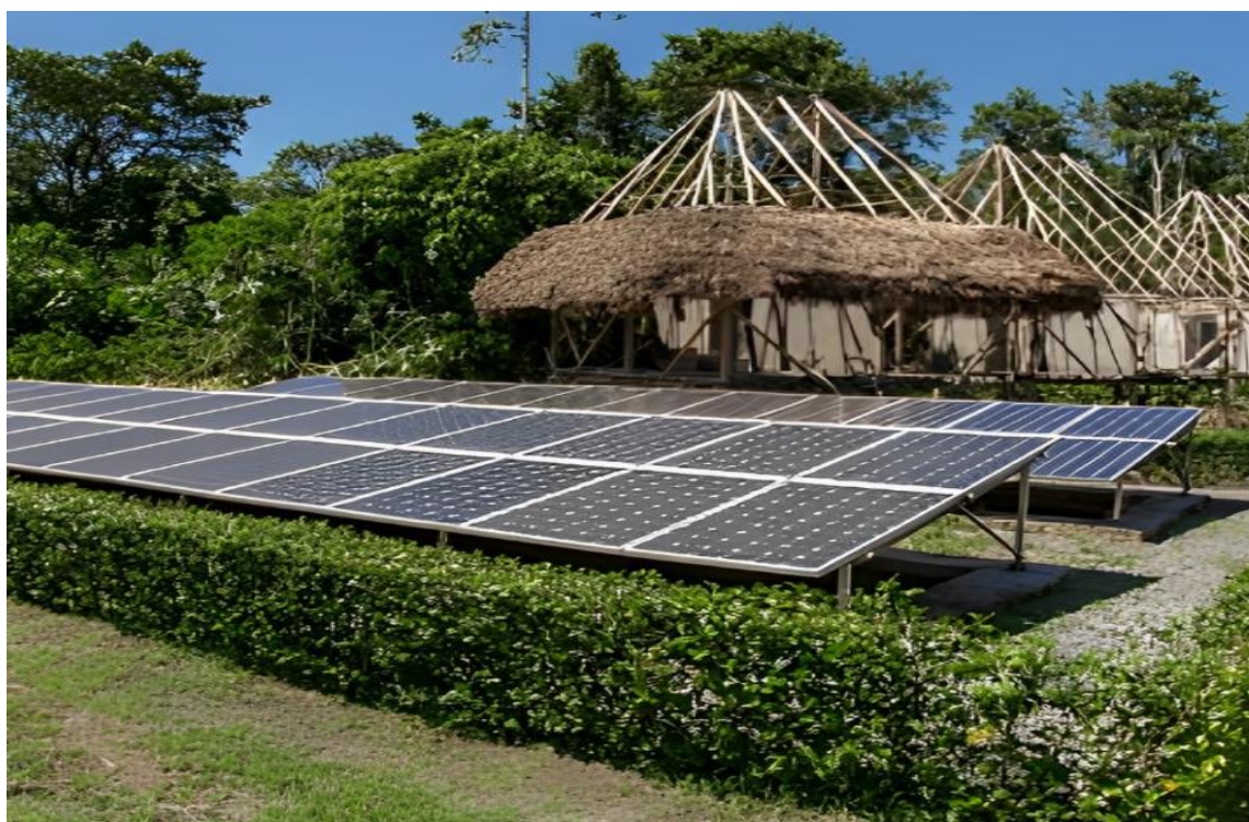
Figura 44: Fotografía sobre colocación de paneles solares para obtener energía de manera sostenible del Napo Wildlife Center Ecolodge.
