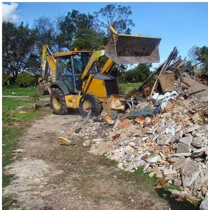
Figura 2: Desperdicios de construcción contaminando el medio natural
