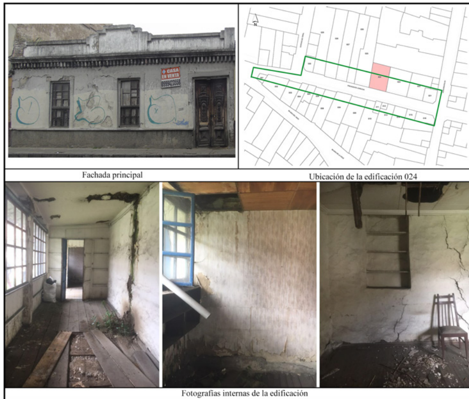
FIGURA 2.34: Levantamiento fotográfico del estado de la edificación del predio 024.
