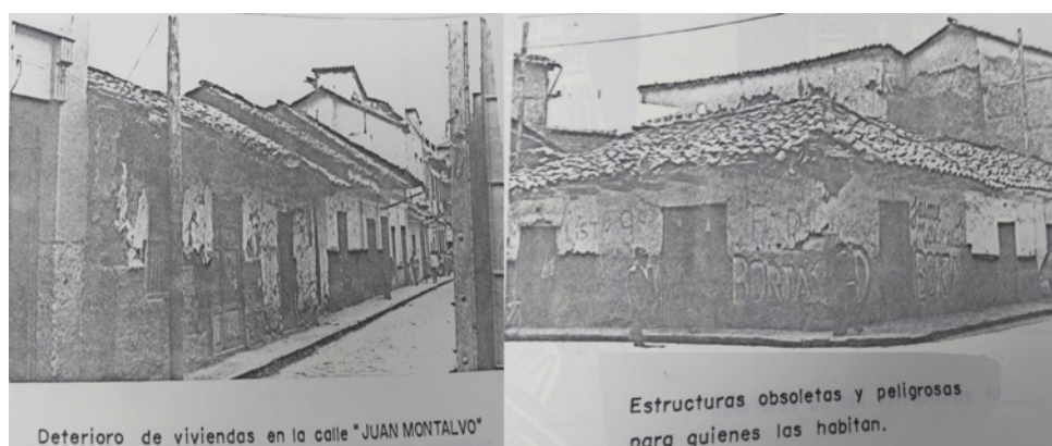
FIGURA 2.5: Deterioro de las edificaciones patrimoniales en El Vado. Fuente: Orellana & Torres (1992). Plan especial El Vado.
