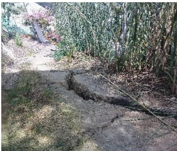
Fig. 23: Deslizamientos de Guabopamba. 2017 Fuente: Propia
