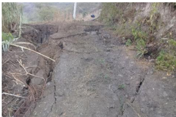
Fig. 27: Deslizamientos en el cantón Santa Isabel. 2017 Fuente: Propia
