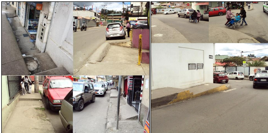
Estado de las aceras
