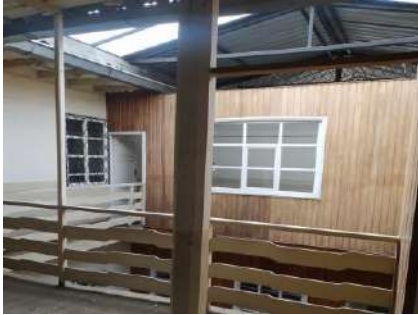
Figura 29: Mamparas de madera interior.
