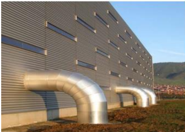
Imagen N°63 “Tubos intercambiadores geotérmicos en Centro de Distribución y Logística
