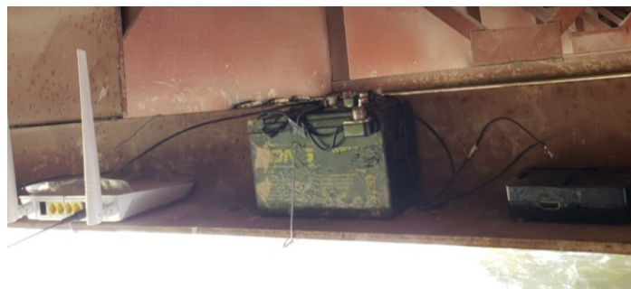
Imagen 12. Instalación de la Raspberry pi 3B+ y Router.
