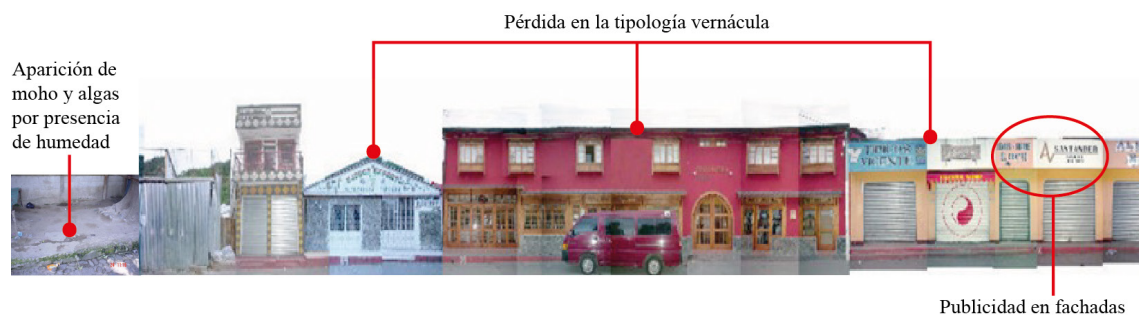
FIGURA 1.40: Se observa la pérdida de la tipología vernácula del lugar del lugar, la colocación de vallas publicitarias y la aparición de moho por la humedad. Fuente: Valenzuela Taracena y Ramírez Arana (2005). Elaboración: Autoras.
